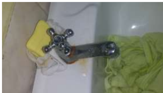
Elemento de lavamanos defectuoso.
