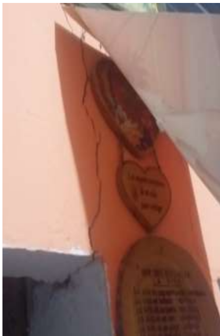
Pared interior cuarteada.
