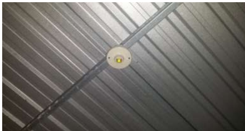
Punto de luz incompleto.
