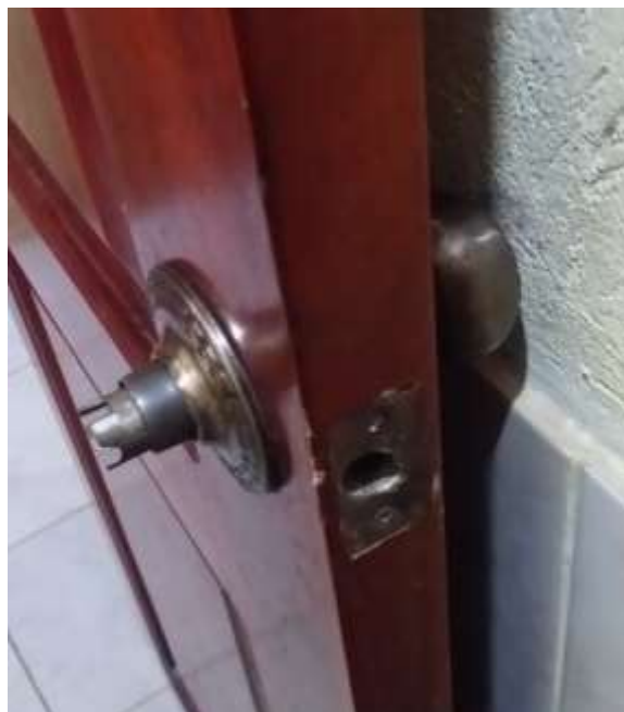
Elemento de la puerta deteriorada (chapa de pomo).
