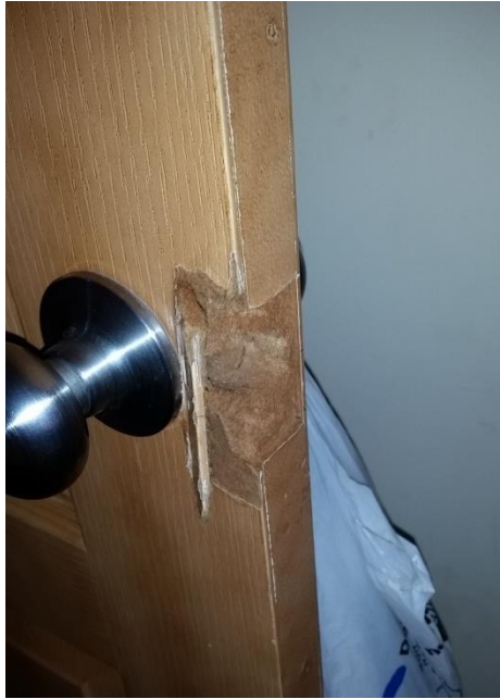
Puertas de cartón defectuosas
