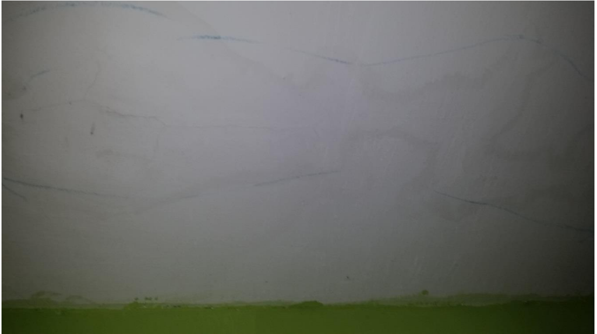
Fisuras y filtraciones en el techo de losa maciza.
