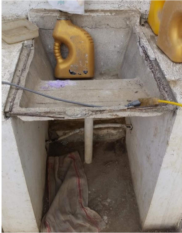
Desprendimiento del recubrimiento de lavandería.
