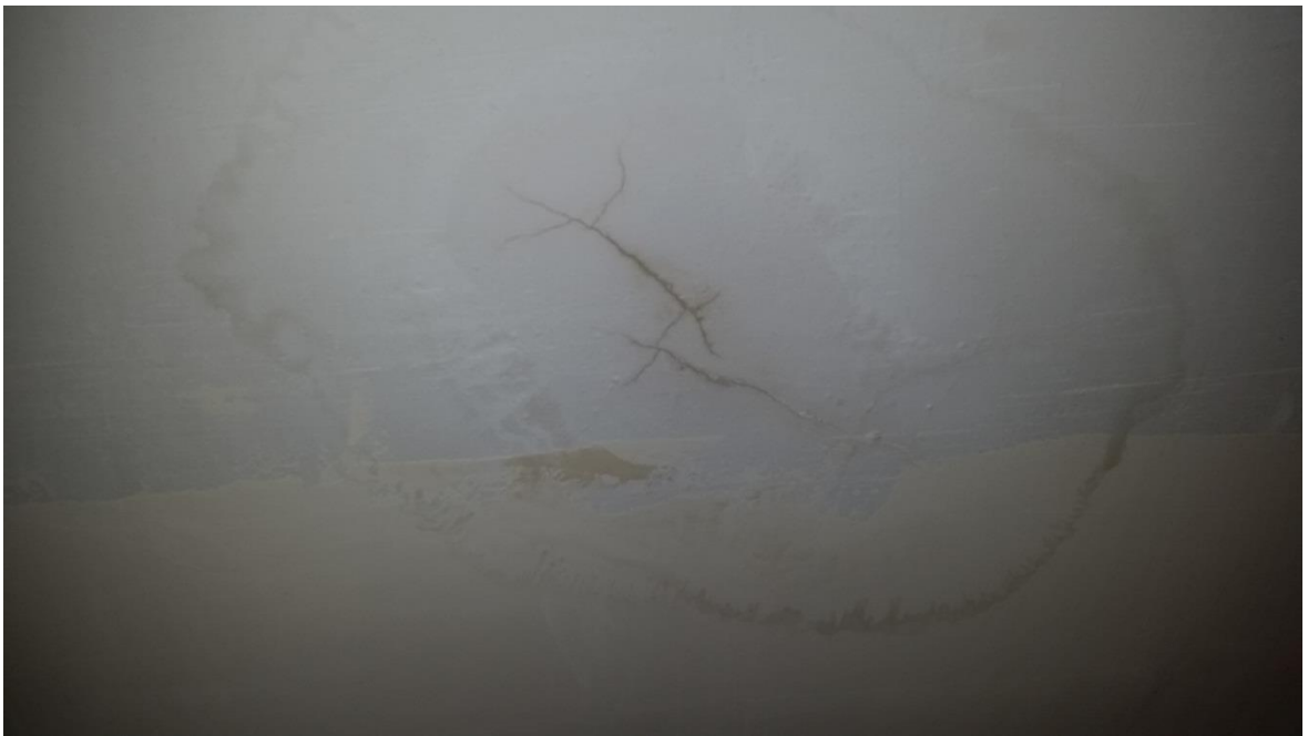
Fisuras y filtraciones en el techo de losa maciza.
