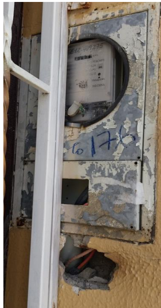
Desprendimiento de recubrimiento en caja de medidor e inseguridad de cables sin aislantes.
