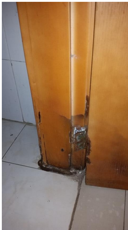
Bisagra defectuosa y puerta deteriorada por la humedad.
