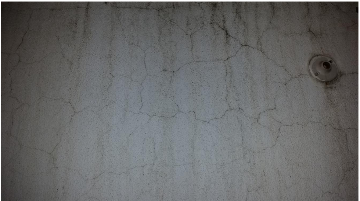
Fisuras producidas por la humedad.
