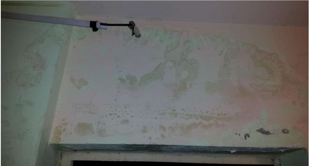
Instalaciones eléctricas defectuosas y filtración en las paredes.
