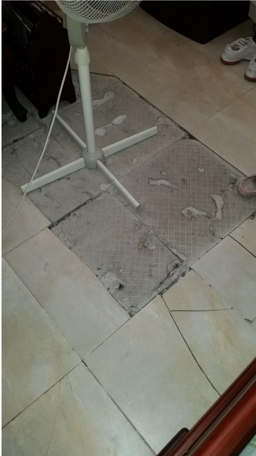
Desprendimiento de cerámica.
