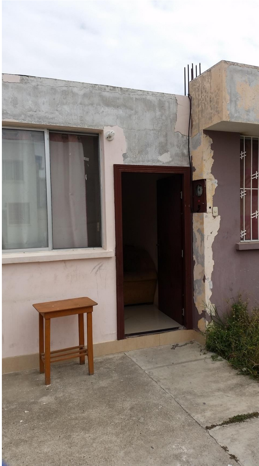
Desprendimiento de recubrimiento.
