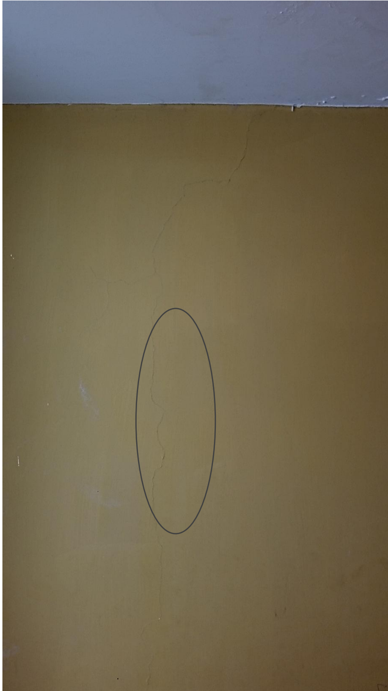
Fisuras de tipo vertical.
