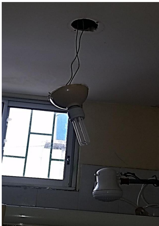
Instalaciones eléctricas defectuosas.
