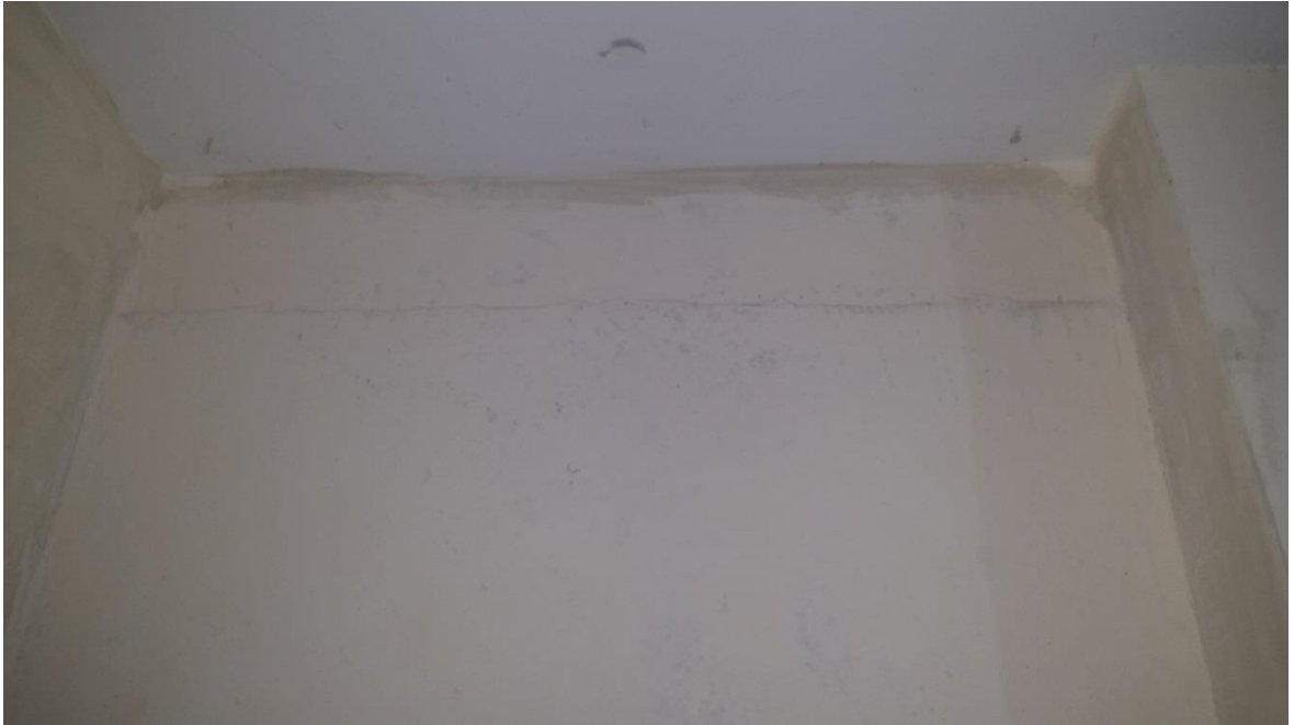
Fisuras de tipo horizontal.
