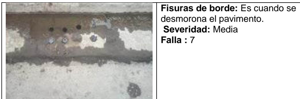
Falla fisura de borde (Autor, 2015)
