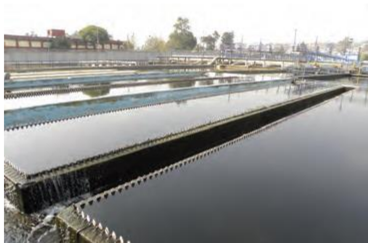
Figura N. 7. Sedimentador de la planta de tratamiento de aguas residuales municipales Cerro de la Estrella, México.
