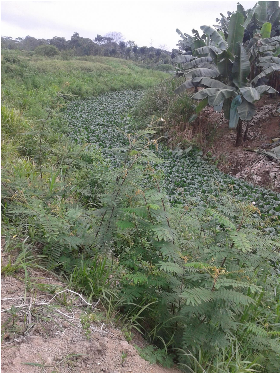
Anexo 14. Parte del canal recolector de aguas residuales cubierto su superficie con lechuguines.
