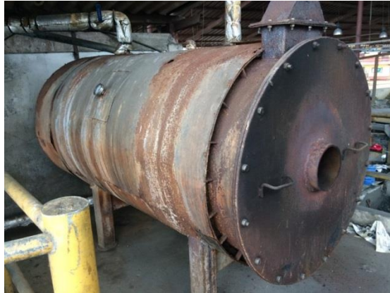
Caldera de la planta
