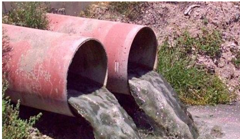
Figura 4 Descarga de aguas residuales.
