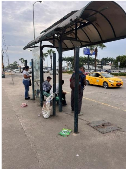
Figura 4: Deterioro de parada de buses
