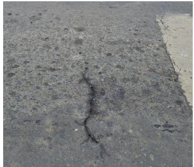
Ilustración 16: Fisura de Bloque de Severidad Media
