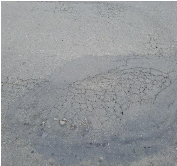
Ilustración 15: Piel de Cocodrilo de Alta Severidad
