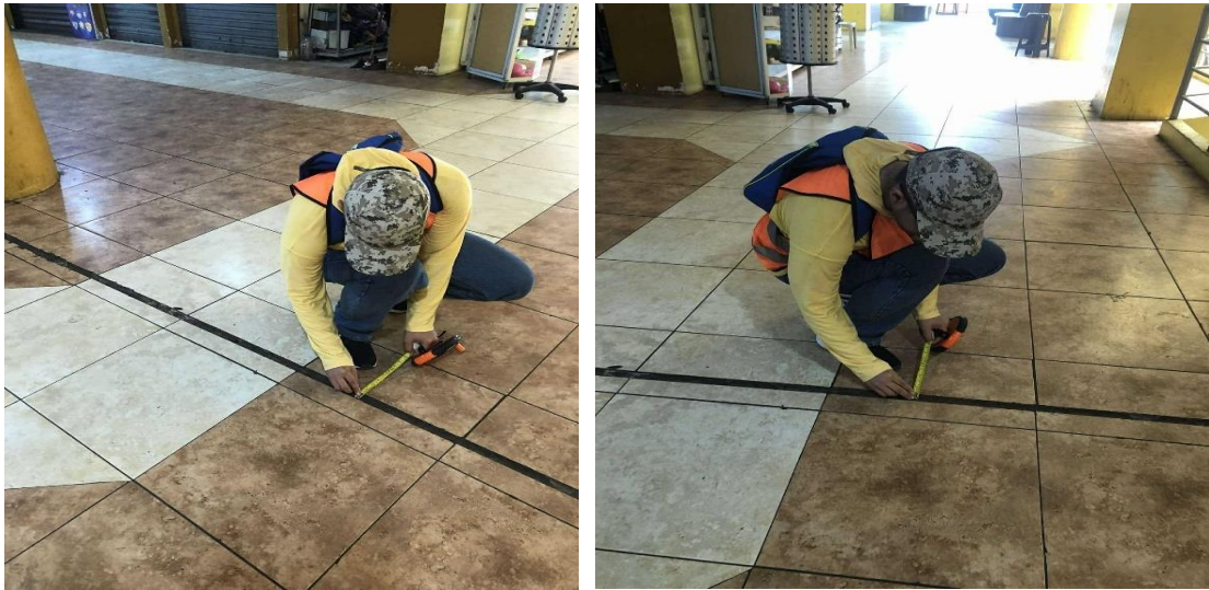
Ilustración 44.- Medición de la junta de construcción que divide al bloque N°1 y N°2 del bloque N°3 localizada en 1era planta alta.
