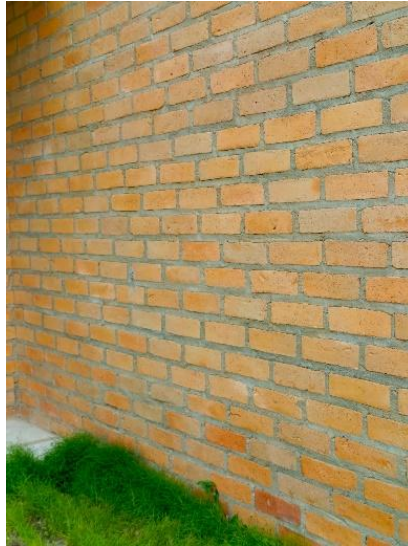
Figura 1 Pared de ladrillo artesanal
