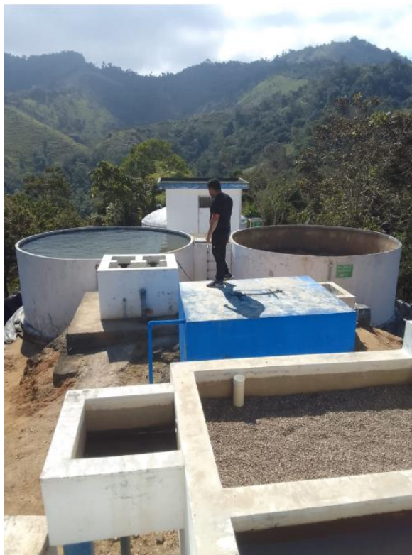
Ilustración 2: Recorrido por la Planta de Tratamiento
