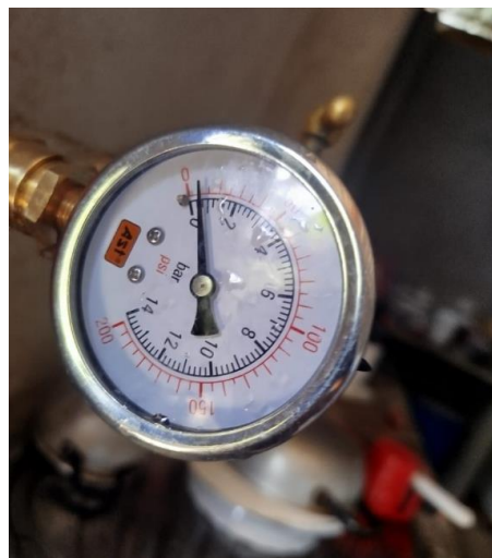
Ilustración 6: Medición de presión en el barrio “Los Remedios”
