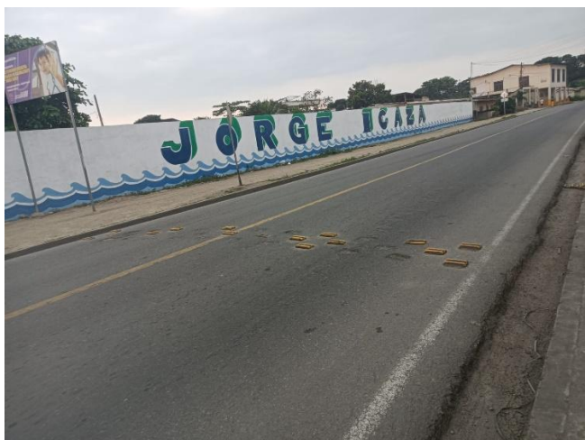
Figura 14. Señalización horizontal desgastada
