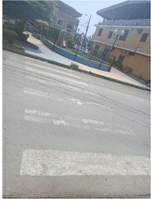
Figura 19. Señal horizontal desgastada
