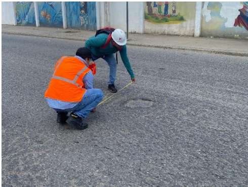
Ilustración 8: Identificación de fallas
