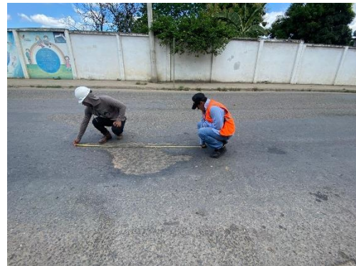
Ilustración 9: Identificación de fallas
