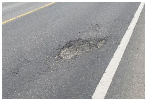
Ilustración 4 :Estado de la Vía
