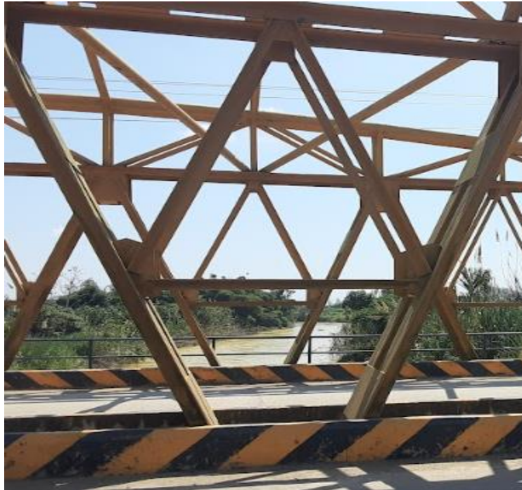
Ilustración 8 Estado de Puntales, Refuerzos y Celosía
