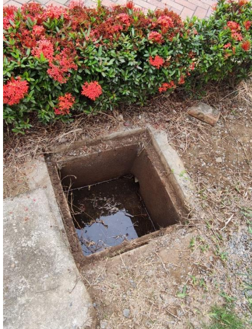
Imagen 5: Evidencia de agua estancada en los pozos
