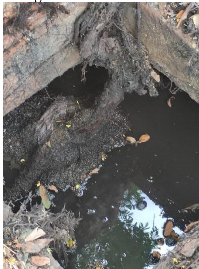
Imagen 10: Pozo en mal estado
