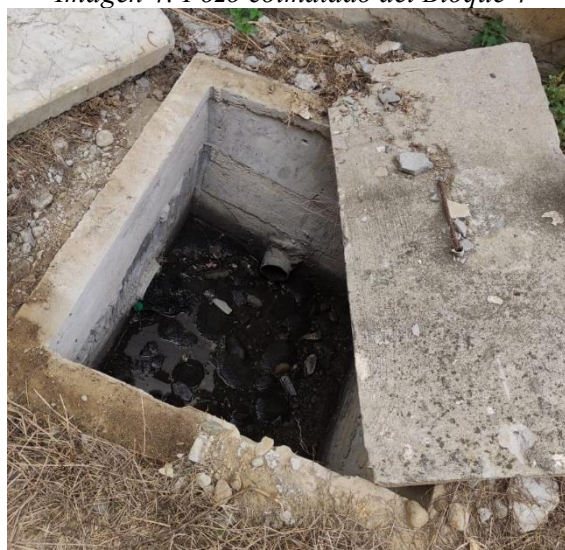
Imagen 4: Pozo colmatado del Bloque 4
