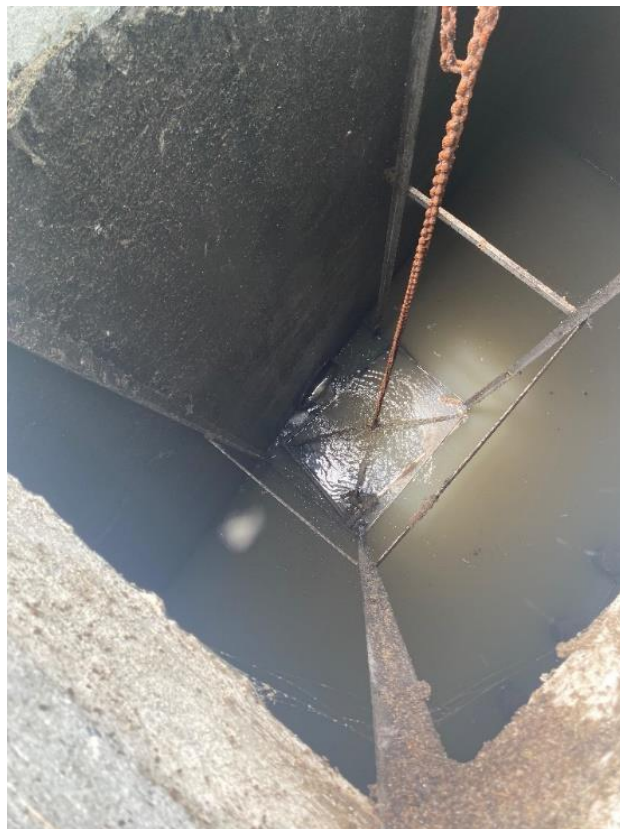
Figura 2. Ingreso de afluente a la Planta de Tratamiento
