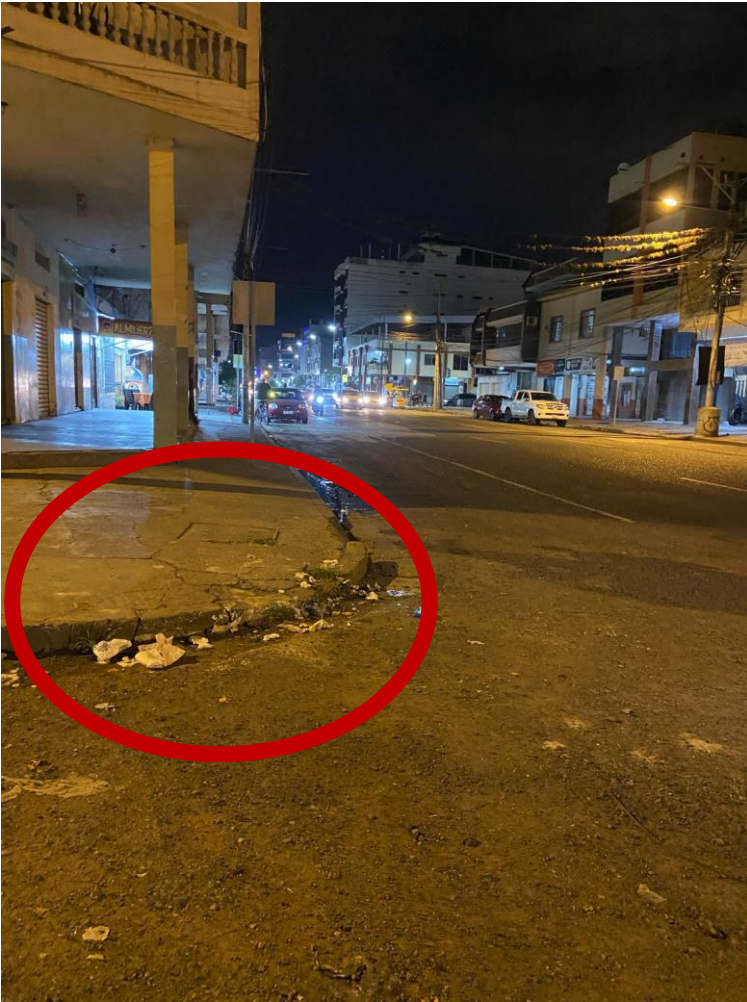
Ilustración 20 Mal Estado de la Acera
