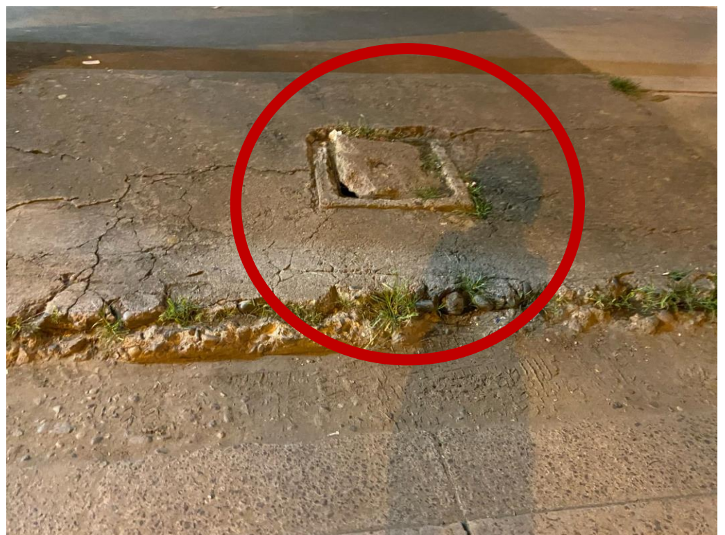
Ilustración 19 Mal Estado de la Acera
