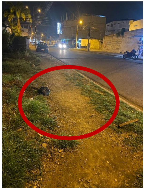
Ilustración 21 Mal Estado de la Acera
