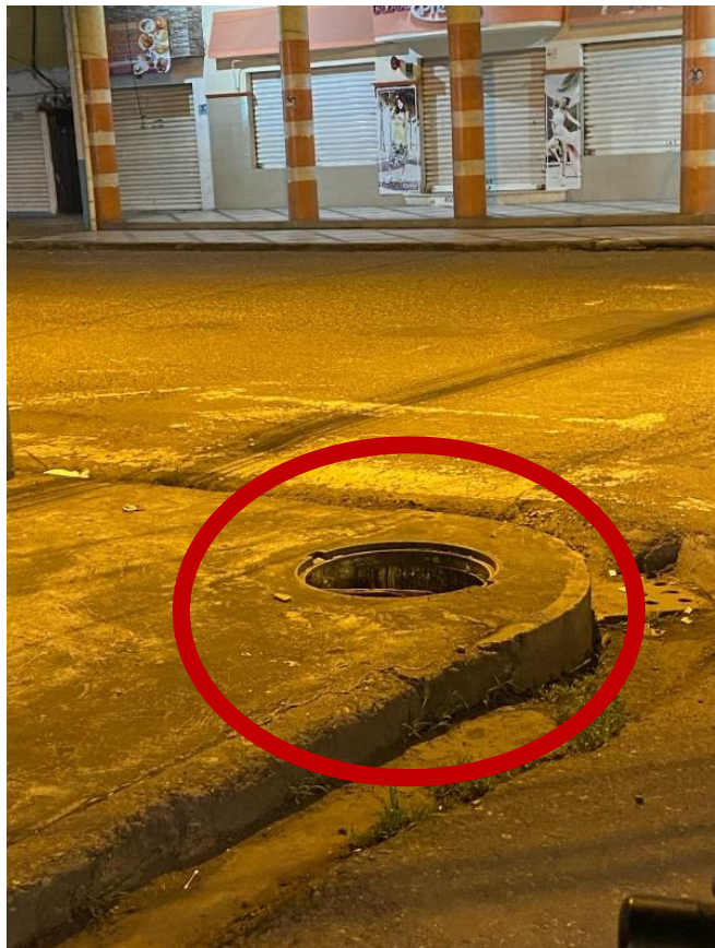
Ilustración 29 Mal Estado de la Acera
