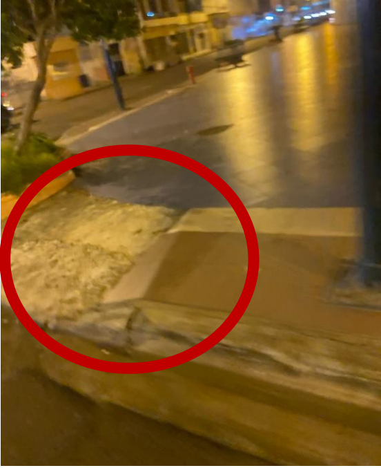
Ilustración 27 Mal Estado de Accesos para personas con discapacidad.
