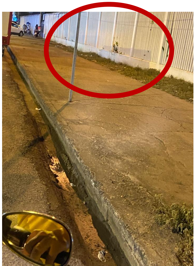
Ilustración 16 Mal Estado de la Acera
