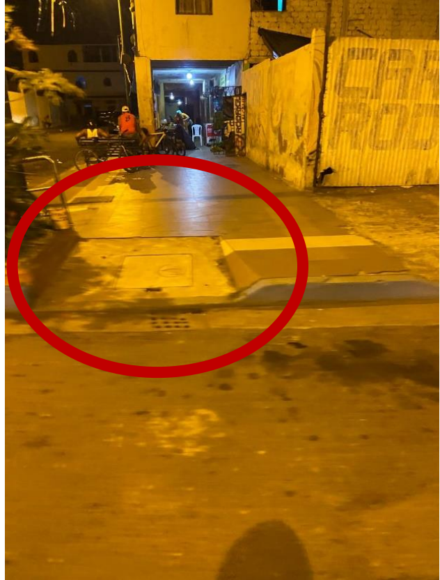
Ilustración 28 Mal Estado Acceso a personas con discapacidad.
