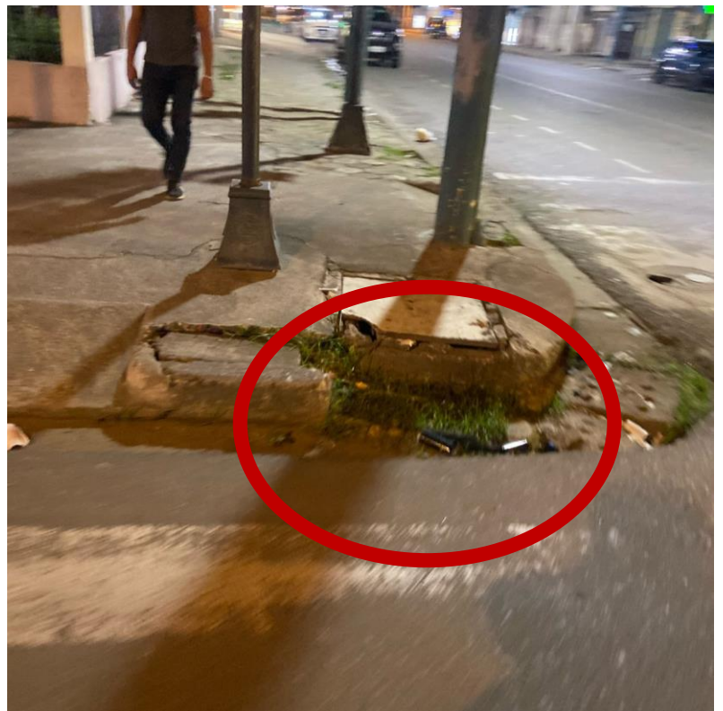
Ilustración 22 Mal Estado de la Acera
