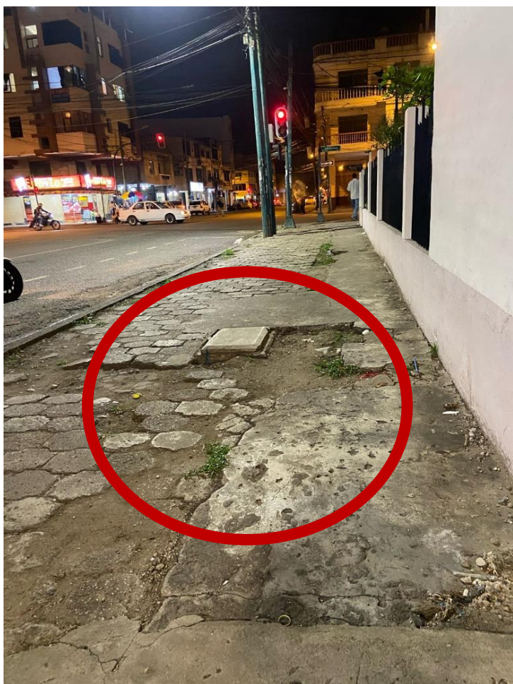
Ilustración 24 Mal Estado de la Acera
