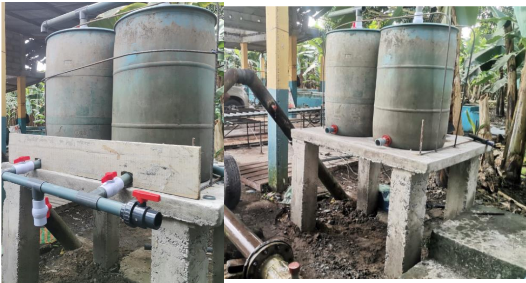
Anexo 3: Instalación del sistema de inyección de fertilizante
