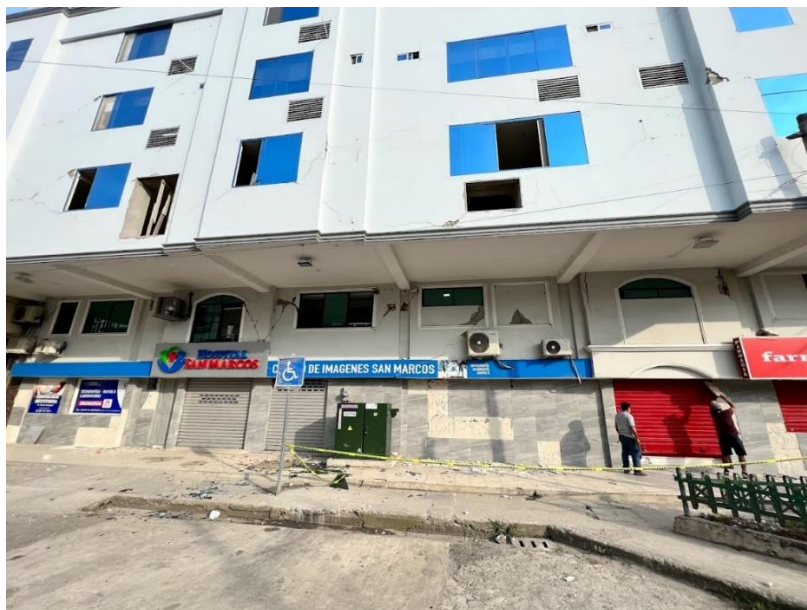
Ilustración 59: Daños en la fachada y paredes del voladizo de la Clínica San Marcos
