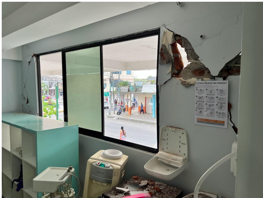
Ilustración 64: Colapso parcial de paredes en la zona del voladizo de la clínica San Marcos
