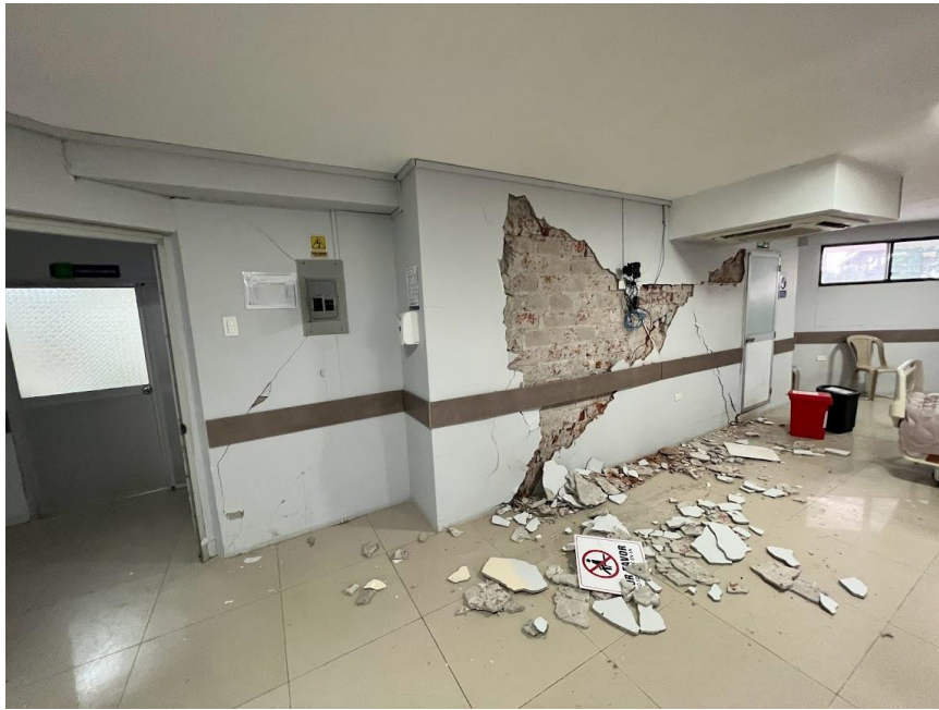
Ilustración 61: Daños en mampostería interior de la clínica San Marcos
