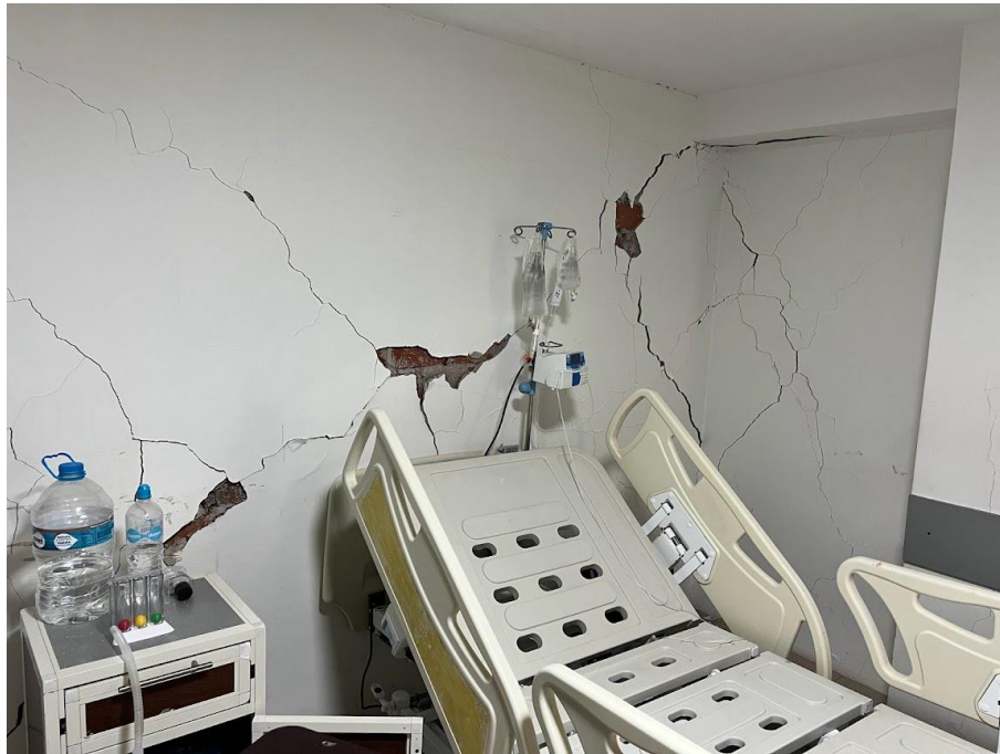
Ilustración 63: Agrietamiento de paredes de la clínica San Marcos
