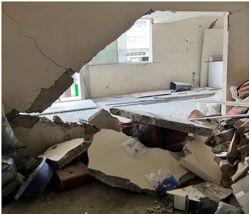
Ilustración 62: Colapso de pared interior de la clínica San Marcos
