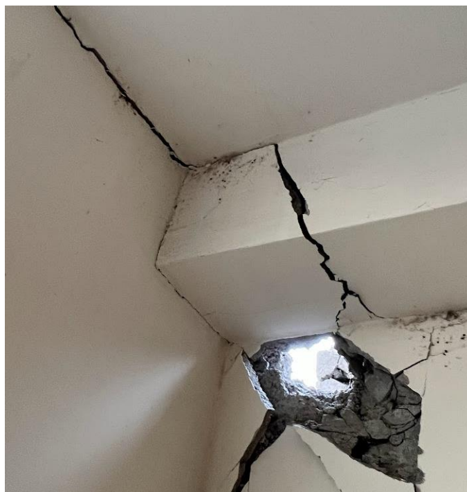
Ilustración 60: Fallo de viga por corte en la clínica San Marcos
