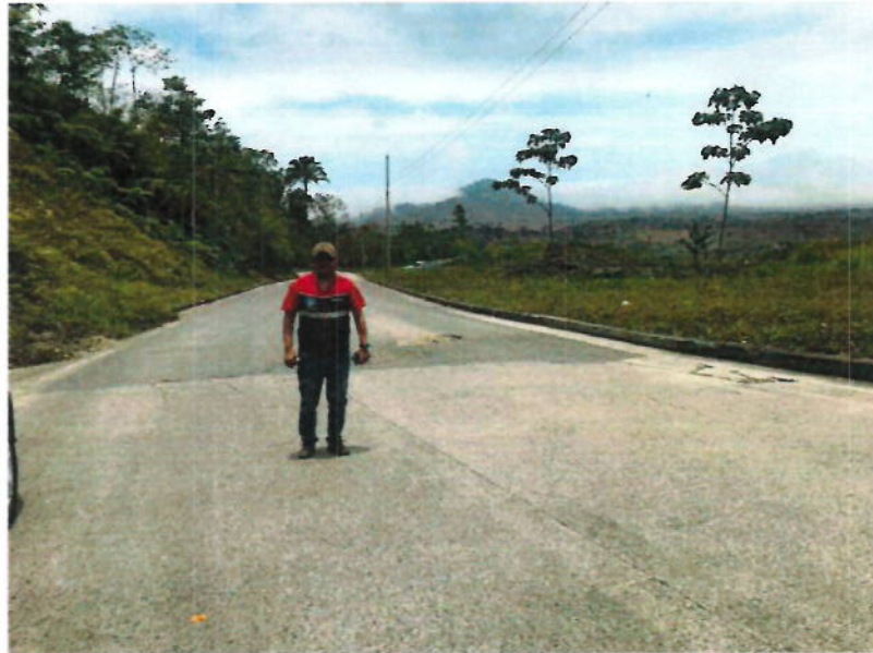
Ilustración 20 Fallas en vía a Arenillas
