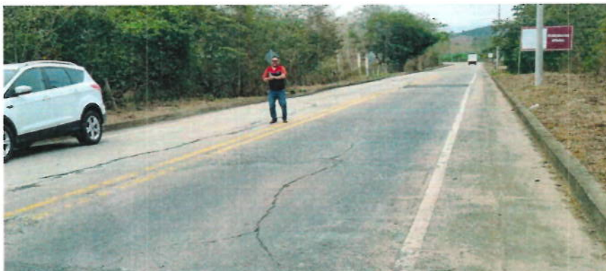
Ilustración 24 Fallas en vía a Arenillas
