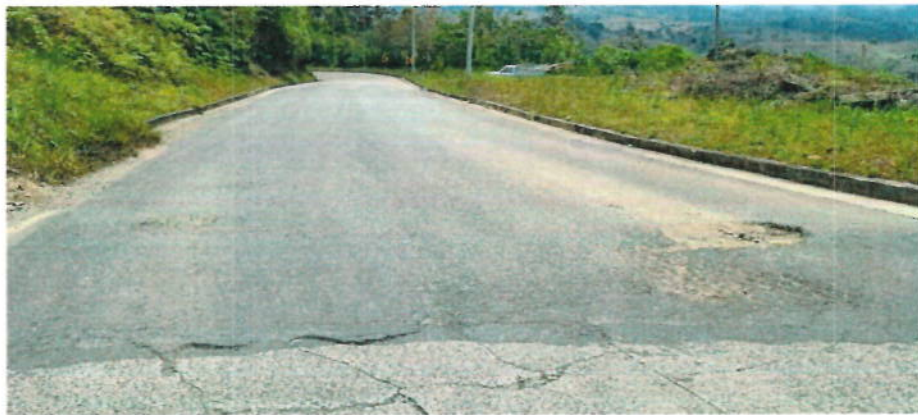
Ilustración 6 Fisuras en hormigón
