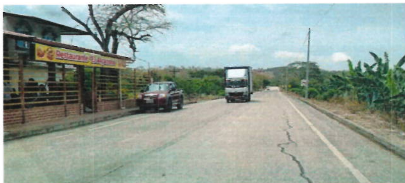
Ilustración 22 Fallas en vía a Arenillas
