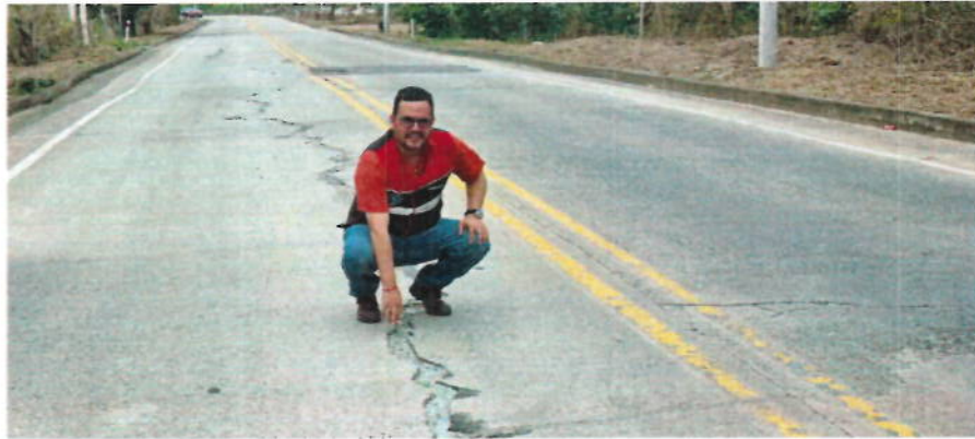
Ilustración 25 Fallas en vía a Arenillas
