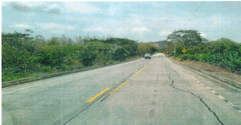
Ilustración 21 Fallas en vía a Arenillas
