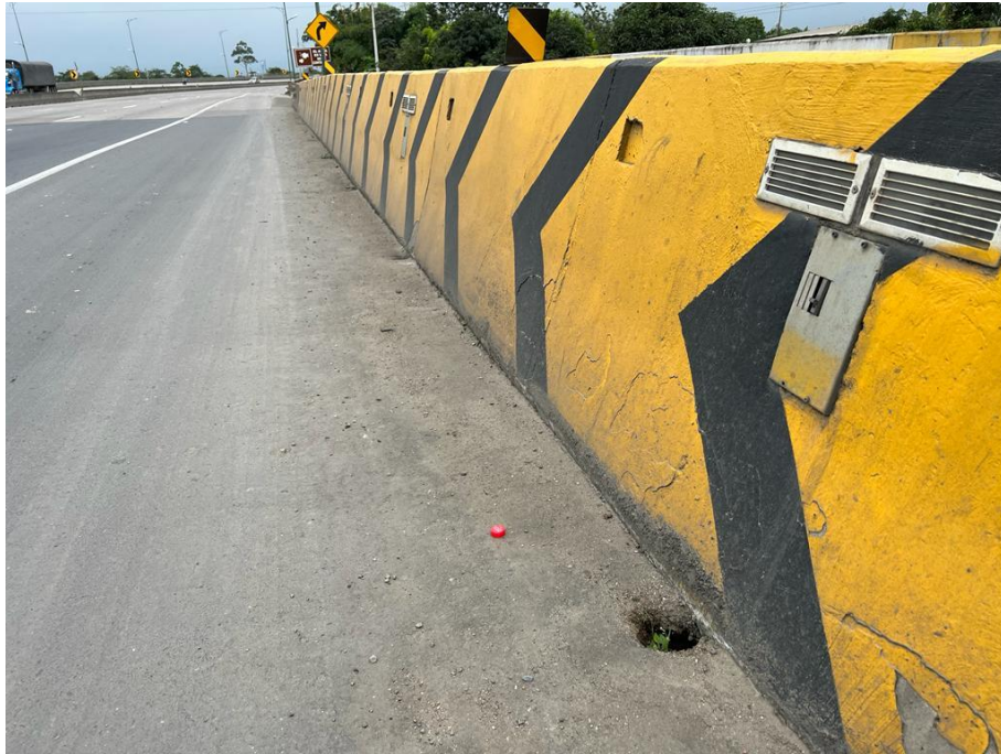
Ilustración 5 Barrera de protección
