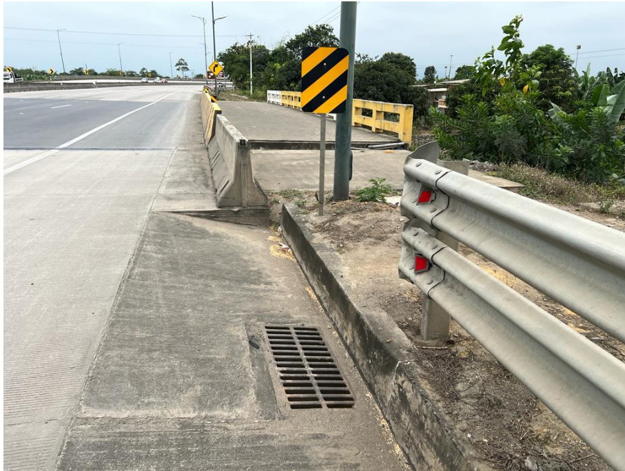
Ilustración 3 Sumide de aguas lluvias
