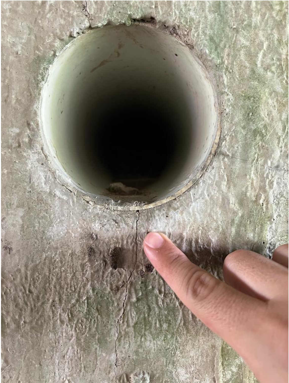
Ilustración 18 Fisuras en estructura
