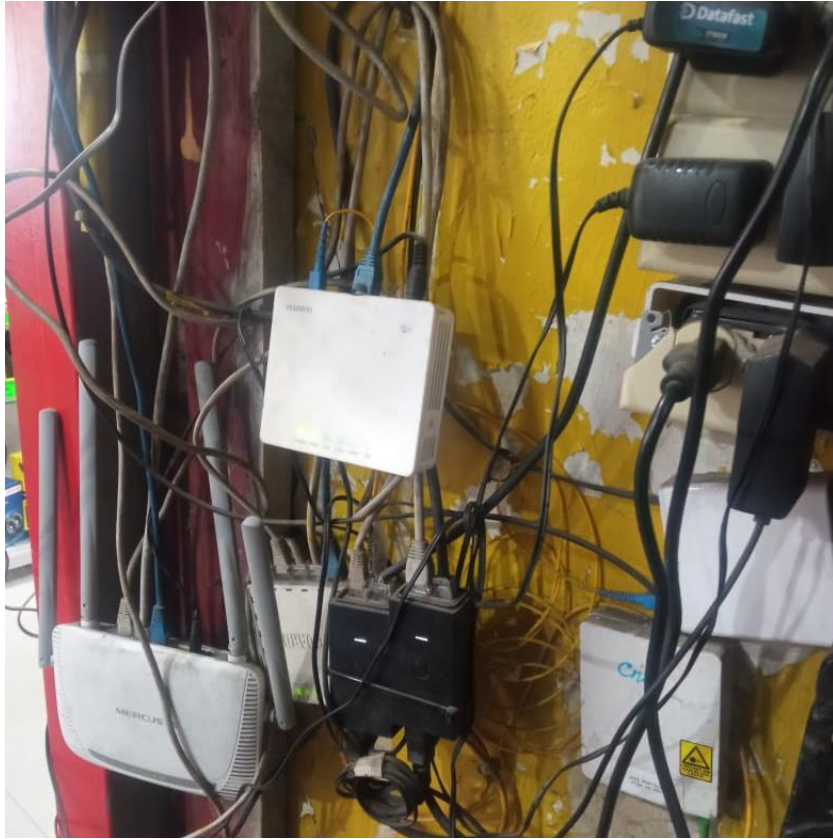
Figura 19. Estado Actual de Router de Borde
