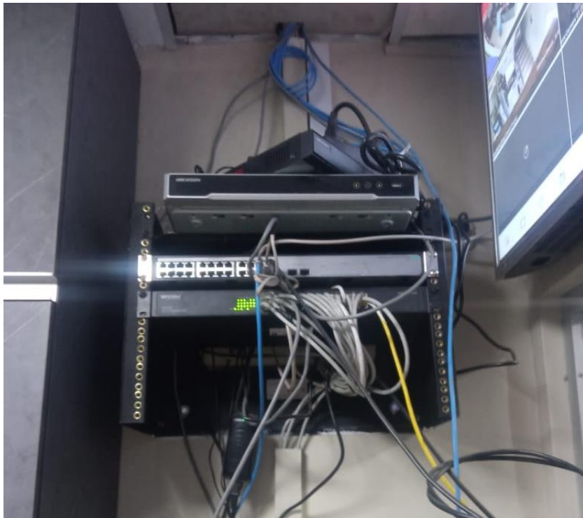
Figura 20. Estado Actual de Rack de Switch
