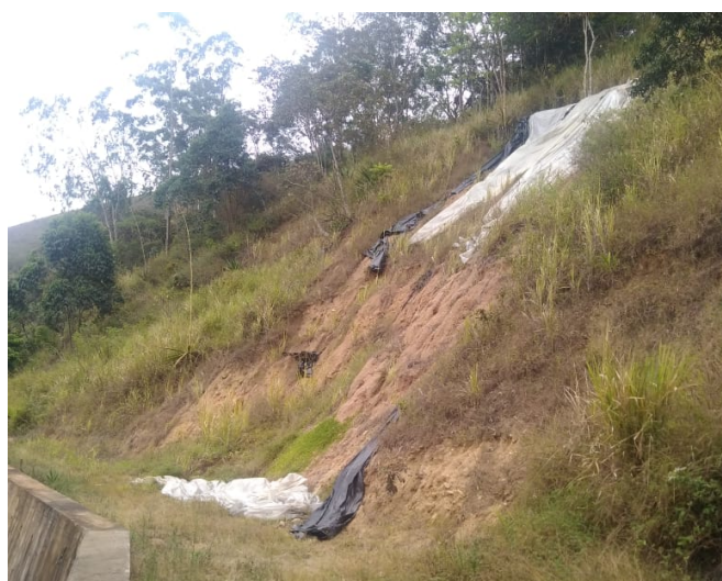
Fig. 2. Talud adyacente al hospital Luis Moscoso Zambrano.
