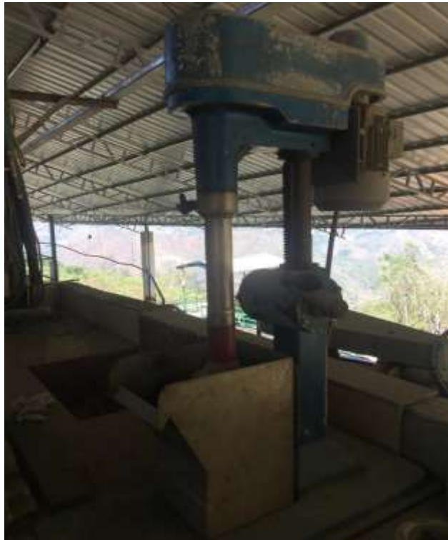
Anexo 9 Celda de Flotación tipo DENVER
