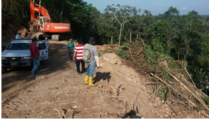
Figura 8: Apertura de vía para transporte y protección de la Subcuenca Río Casacay
