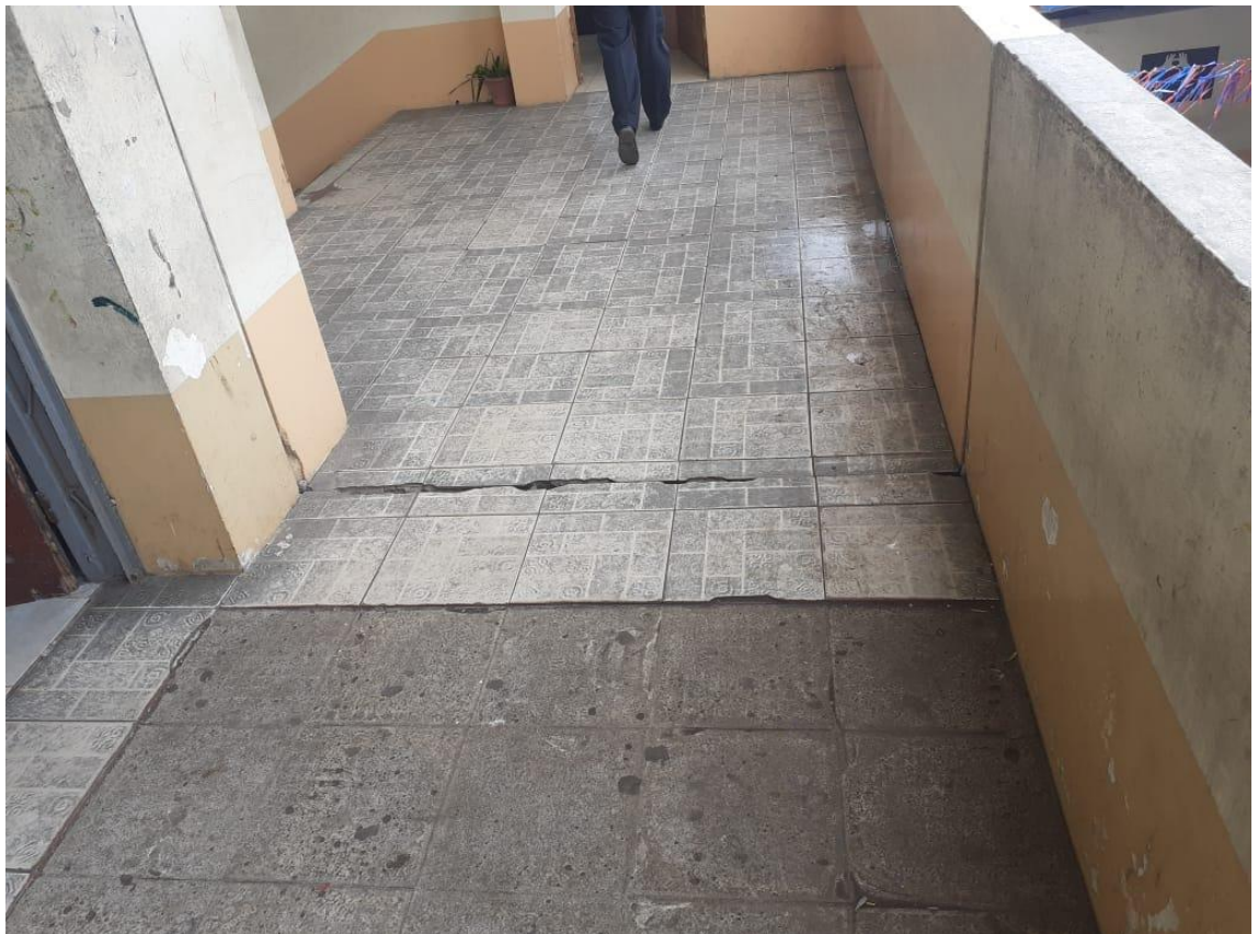
Anexo 6: Presencia de corrosión en el piso
