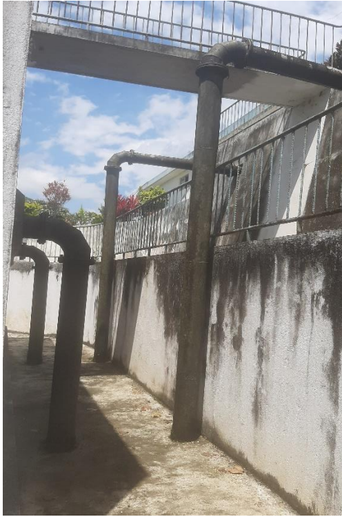
Tubería de ingreso a la cámara de filtración
