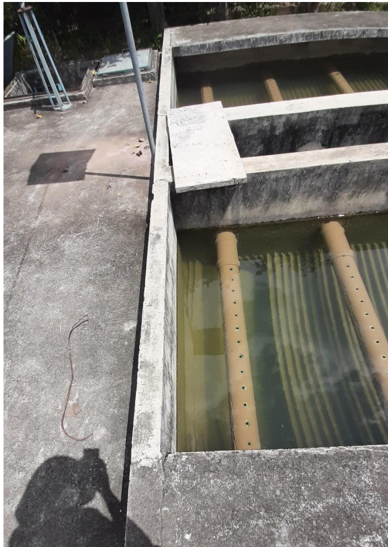
Las placas se encuentran montadas una sobre otra por la excesiva cantidad de lodo acumulados
