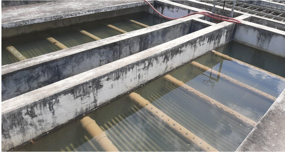
Sedimentadores con presencia de gran cantidad de lodos en las placas inclinadas
