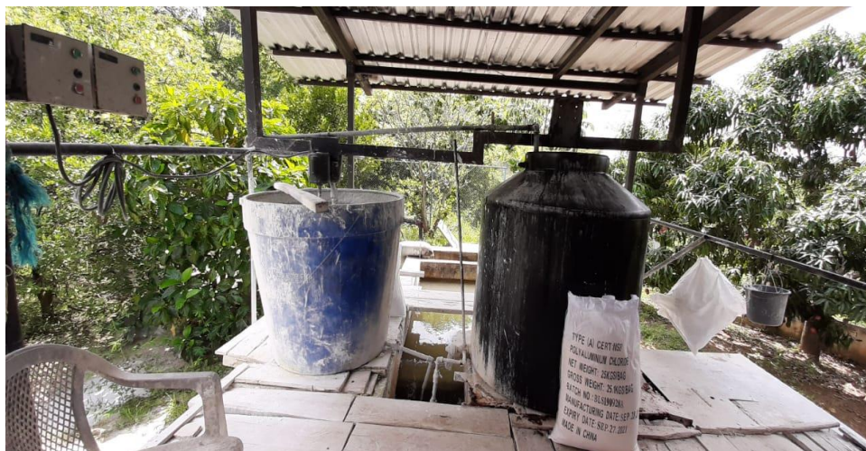
Proceso de mezcla rápida donde es agregado el cloruro de Polialuminio y la cal
