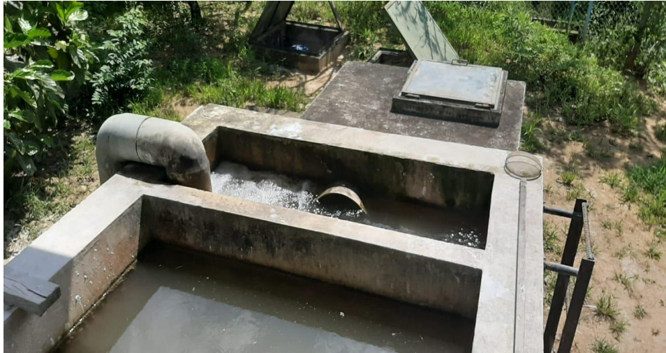
Tuberías de ingreso a la planta de tratamiento desde la captación
