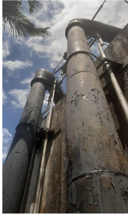
Tuberías de drenaje del agua del retrolavado
