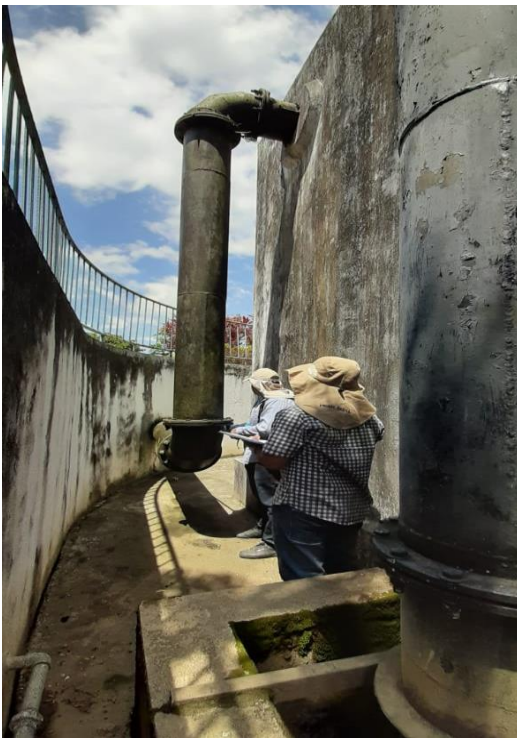
Tubería de salida del agua filtrada
