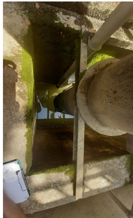
Deposito del agua de retro lavado
