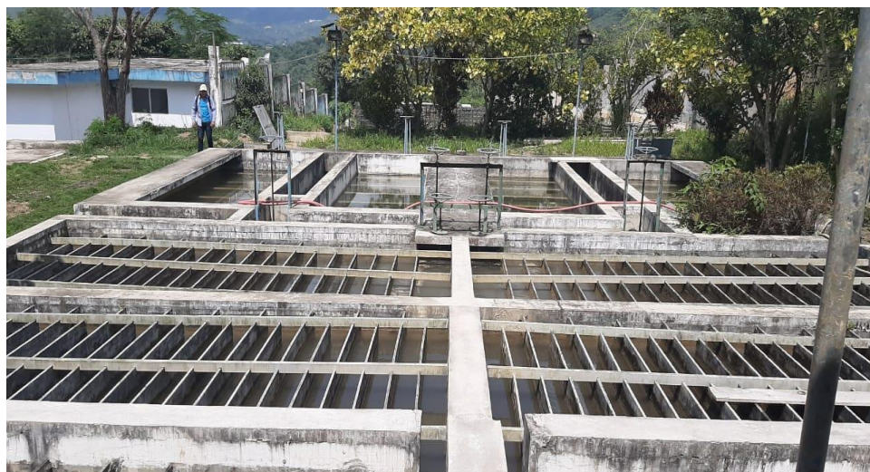
Floculadores de flujo horizontal
