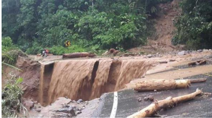
Figura 7. Socavón en el sector Buenaventura
