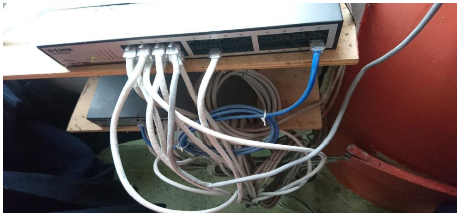
Ilustración 4. Estado de las instalaciones de datos
