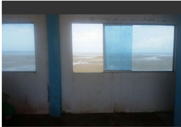
Figura Nro 15 Ventanales en mal estado
