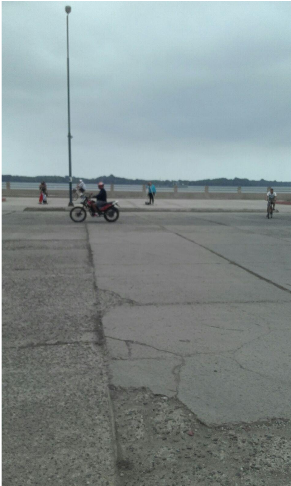
Vía del malecón en todo lo ancho se encuentra en malas condiciones debido al agua salada, frente a la iglesia del Puerto.
