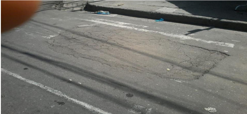
Grafico 3.- Mal estado de la capa de rodadura
