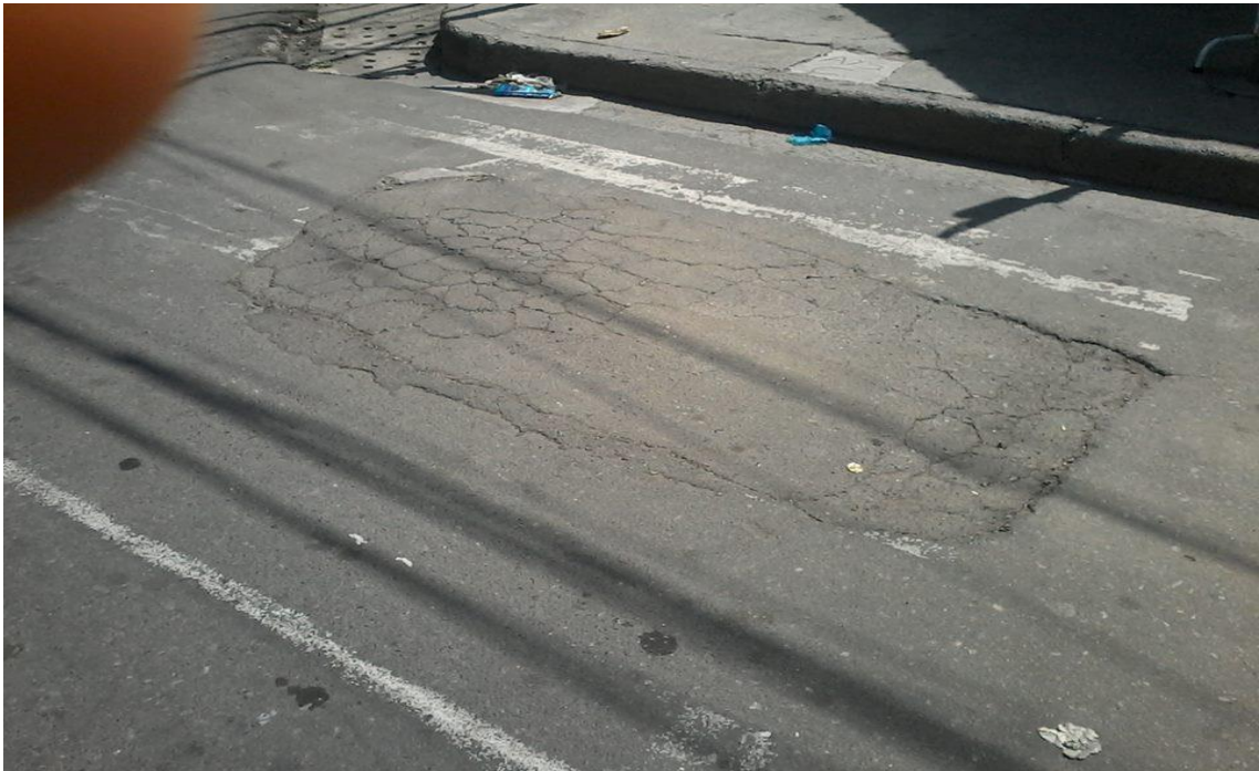
Anexo 6. Deterioro de la capa de Rodadura en la Avenida Arizaga.
