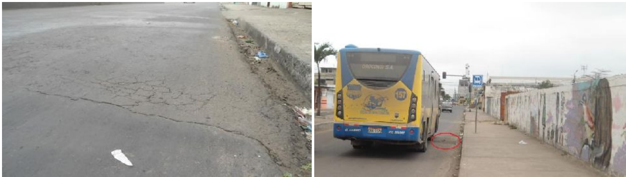
Gráfico 2.24 Deterioro de la capa de rodadura en el tramo de estudio (Fuente: El Autor - 2015)
