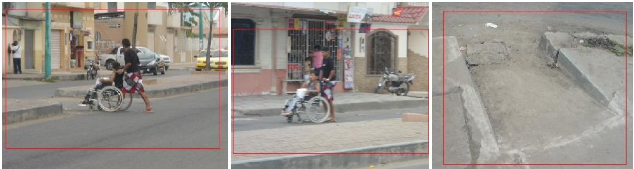
Gráfico 2.22 Infraestructura vial inadecuada para la movilidad de personas discapacitadas en el tramo de estudio (Fuente: El Autor - 2015)
