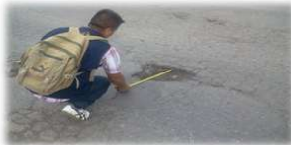
Bache, con pérdida de material de base
