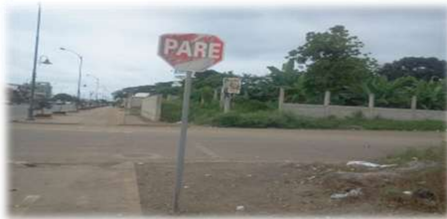
Grafico 4 :Esta señal presenta daños en su estructura derrochándose su pintura perdiendo la importancia para los guías
