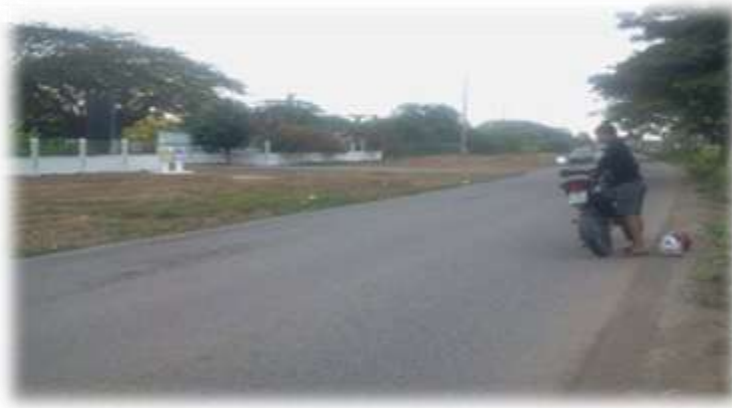
Grafico 10 : Vía en mal estado
