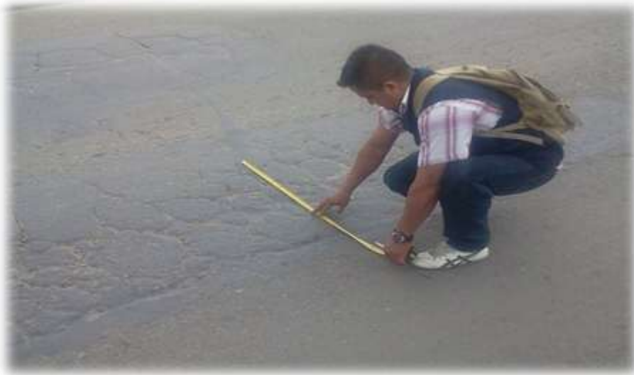
Grafico 13 : Capa de rodadura en mal estado
