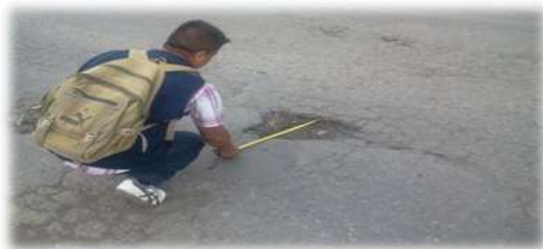
Grafico 14: Capa de rodadura con hueco
