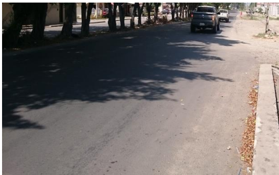
Gráfico 11. Cunetas laterales obstaculizadas Fuente: El autor
