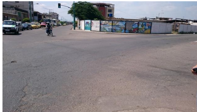
Deterioro total de las demarcaciones sobre el pavimento
