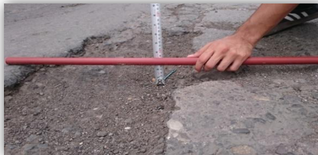
Gráfico 6. Medición de profundidad de fallas en el pavimento. Fuente Fotográfica: El Autor.
