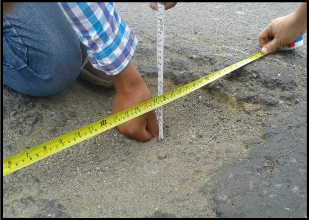
GRAFICO 5 FALLA BACHE AVDA CIRCUNVALACION SUR Fuente: EL AUTOR (2015)
