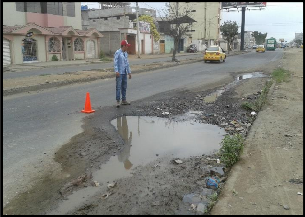
GRAFICO 4 FALLA BACHE AVDA CIRCUNVALACION SUR FUENTE: EL AUTOR (2015)
