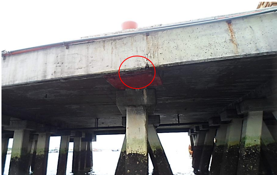
Anexo N° 6. Oxidación de viga ocasionada por la bita
