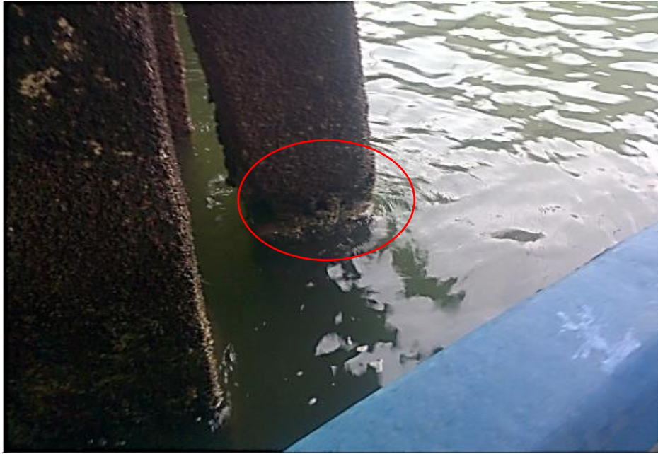
Anexo N° 3. Deterioro del Pilote en la parte inferior
