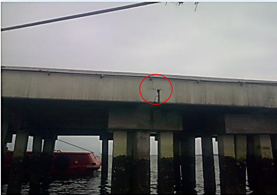
Anexo N° 4. Fisura en la viga lateral del muelle
