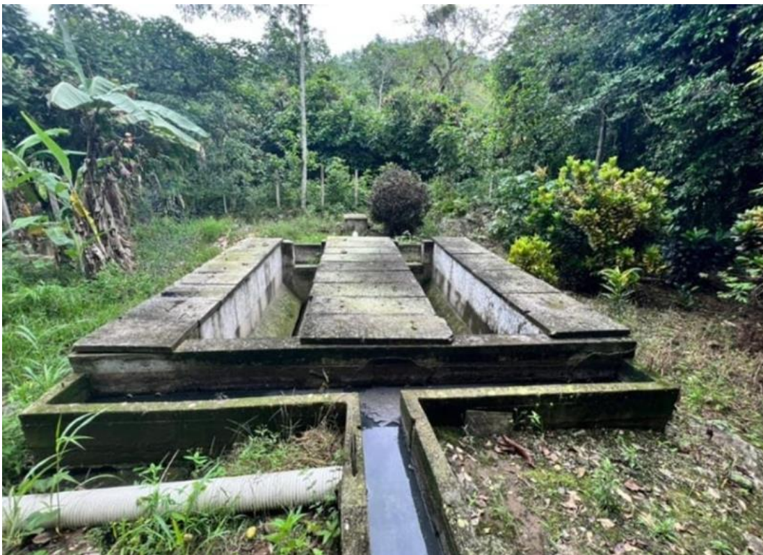
Ilustración 35: Área de la planta de tratamiento de aguas residuales Galayacu
