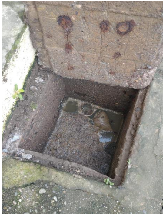
Ilustración 15: Caja de revisión domiciliaria
