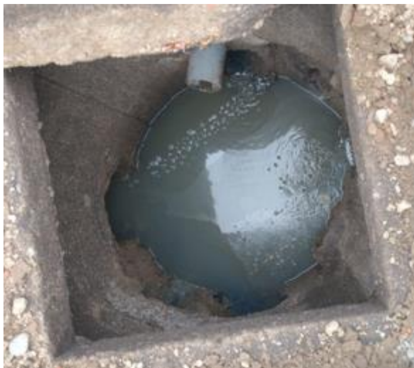
Ilustración 29: Pozos de revisión
