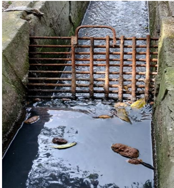
Ilustración 20: Rejas de la PTAR Galayacu
