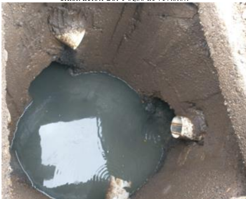
Ilustración 28: Pozos de revisión
