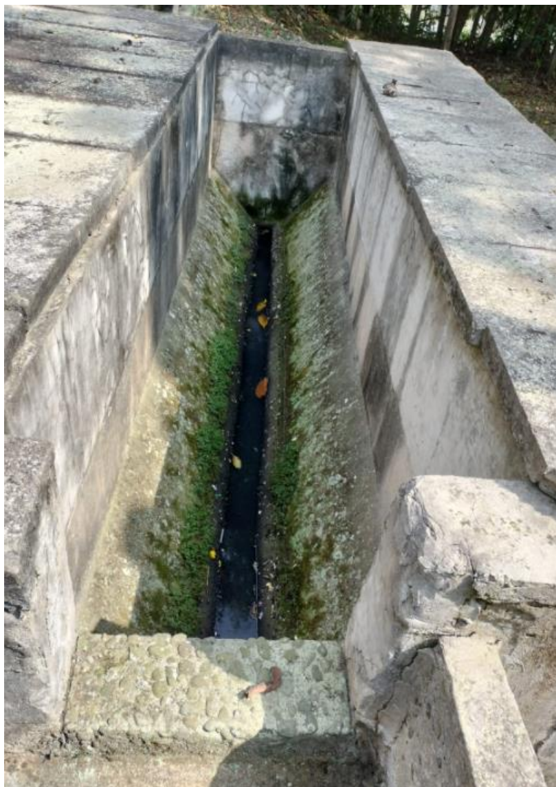
Ilustración 22: Cámaras de sedimentación de la PTAR Galayacu
