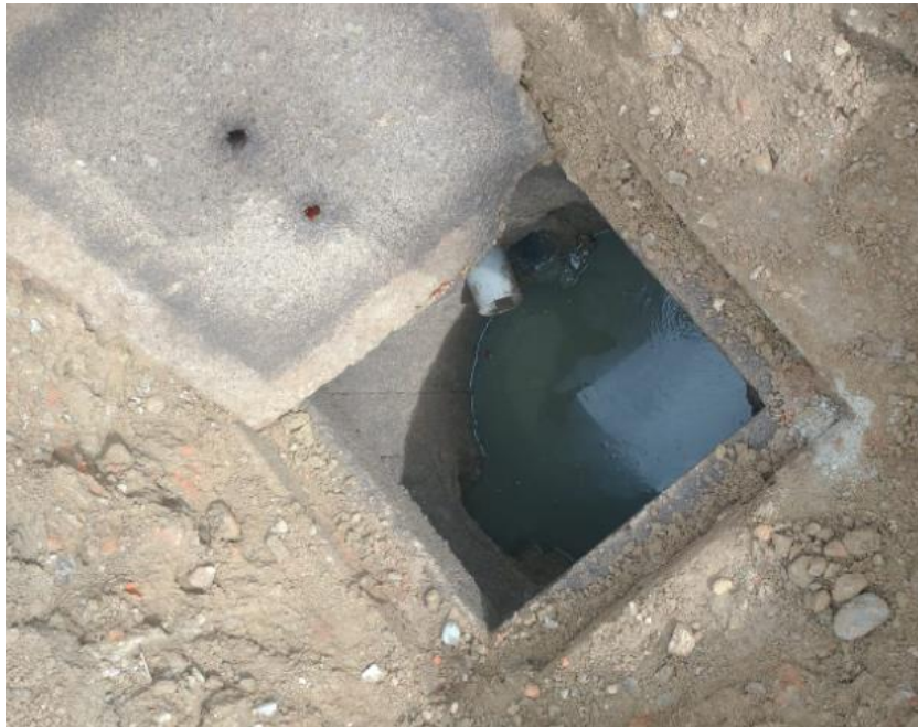
Ilustración 17: Tapas de pozos de revisión
