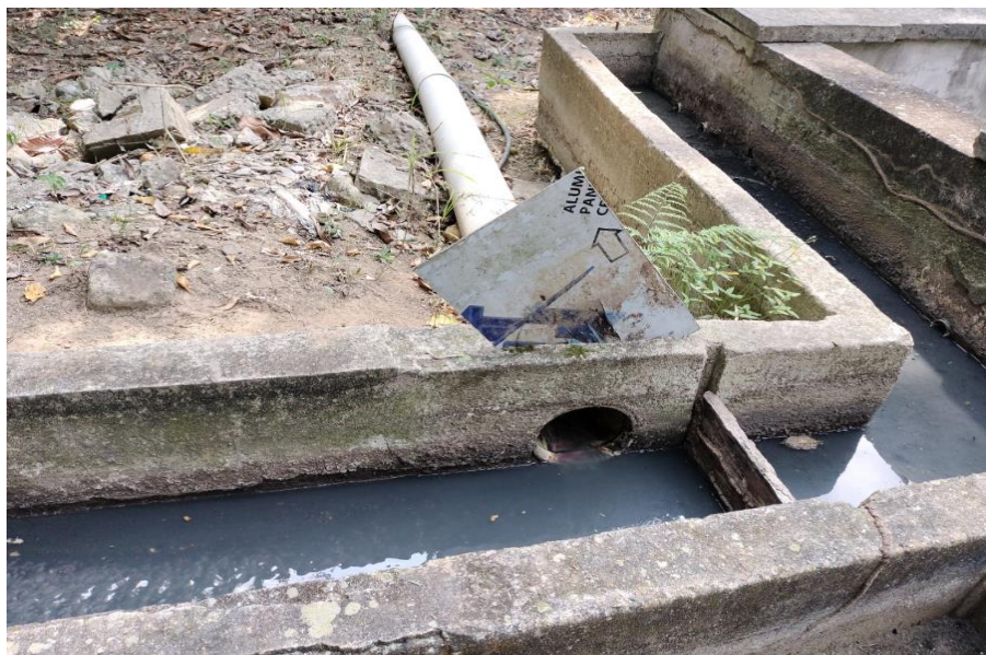
Ilustración 21: Bypass de la PTAR Galayacu
