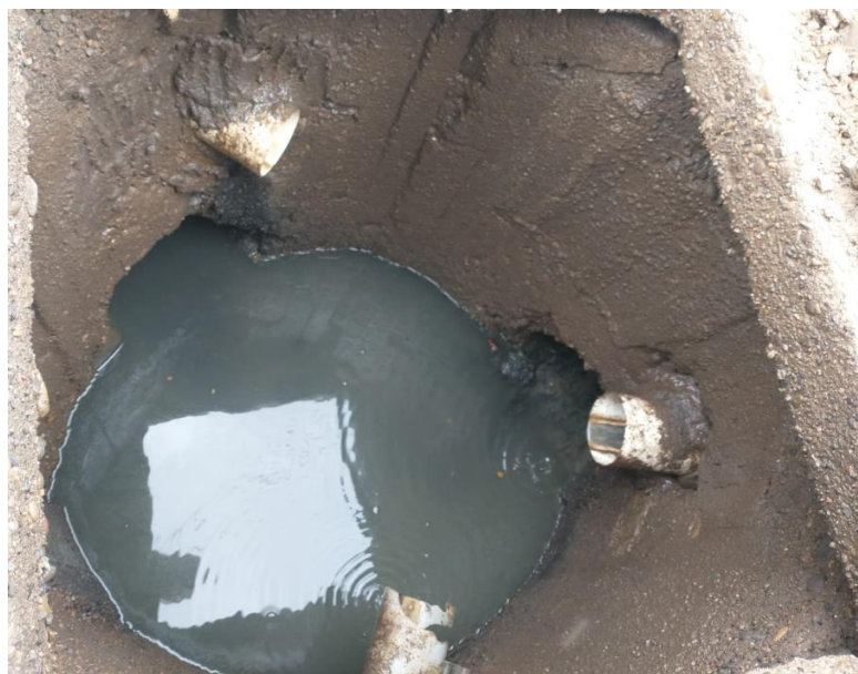
Ilustración 16: Pozos de revisión
