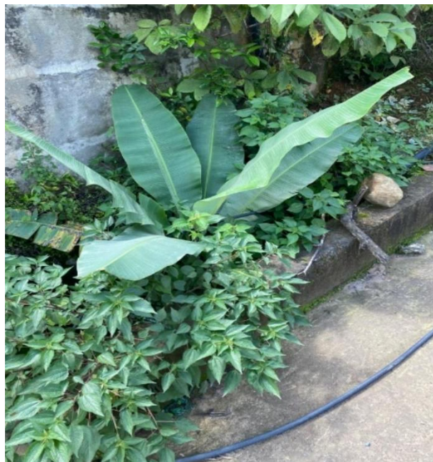
Figura 81 Alcantarilla de funcionalidad mala ubicada en la abscisa 8+699.50
