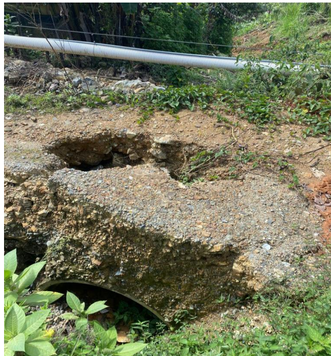
Figura 97 Alcantarilla de funcionalidad mala ubicada en la abscisa 23+812.30
