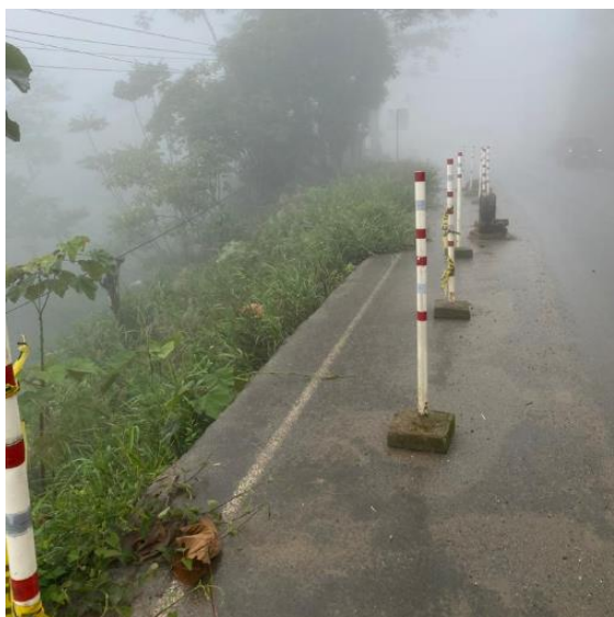
Figura 26 Deslizamiento de terreno de la estructura de pavimento en abscisa 3+295.000
