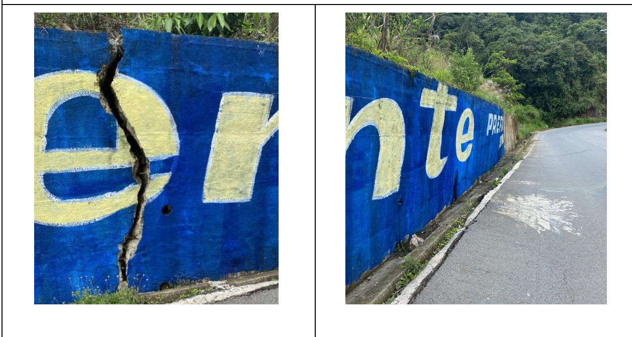
Figura 33 Muro severamente afectado en tramo 5 de la vía Zaruma – Atahualpa
