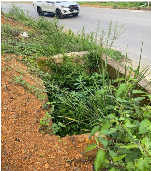
Figura 90 Alcantarilla de funcionalidad mala ubicada en la abscisa 17+945.18
