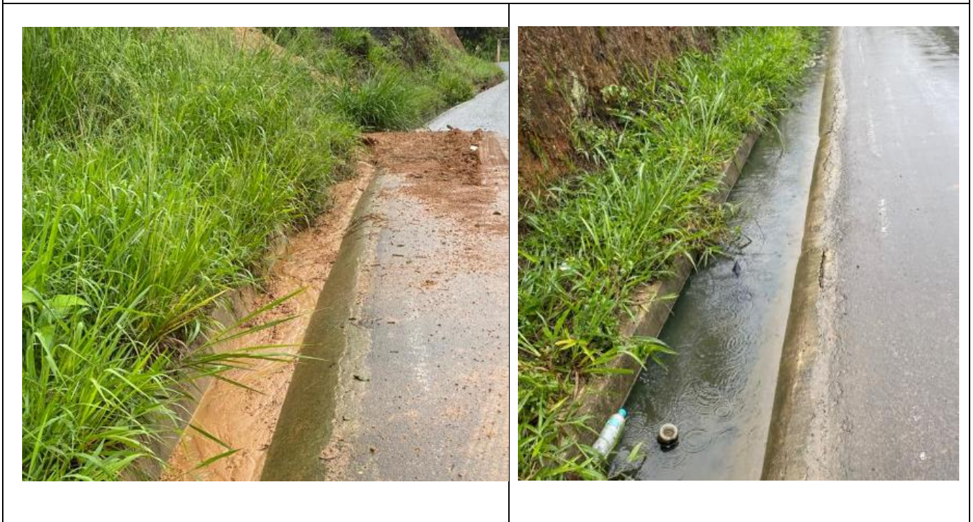
Figura 32 Cuneta colmatada en tramo 1
