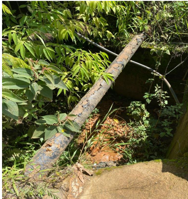
Figura 93 Alcantarilla de funcionalidad mala ubicada en la abscisa 23+626.80
