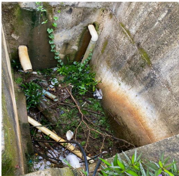
Figura 79 Alcantarilla de funcionalidad mala ubicada en la abscisa 4+162.55
