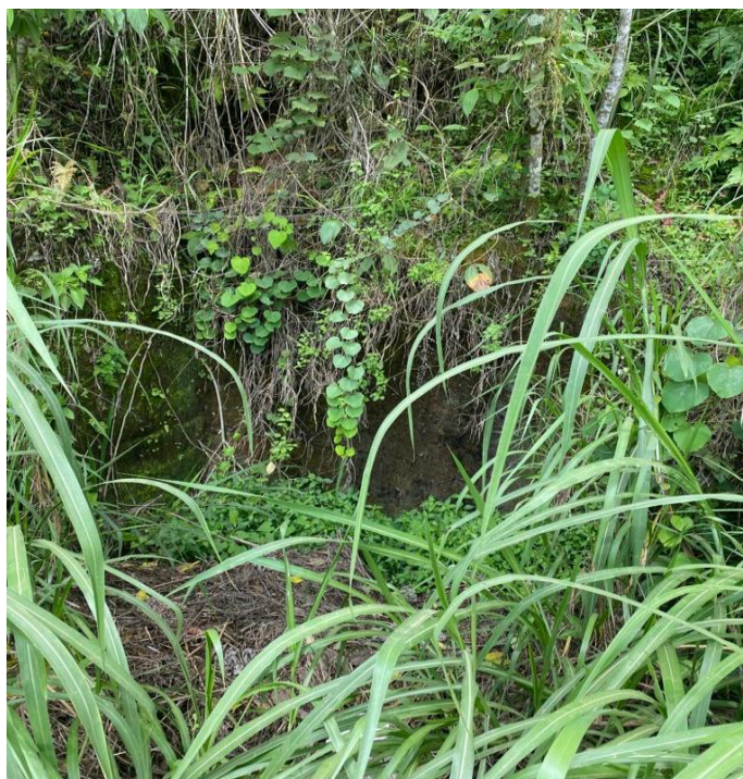
Figura 76 Alcantarilla de funcionalidad mala ubicada en la abscisa 3+223.90
