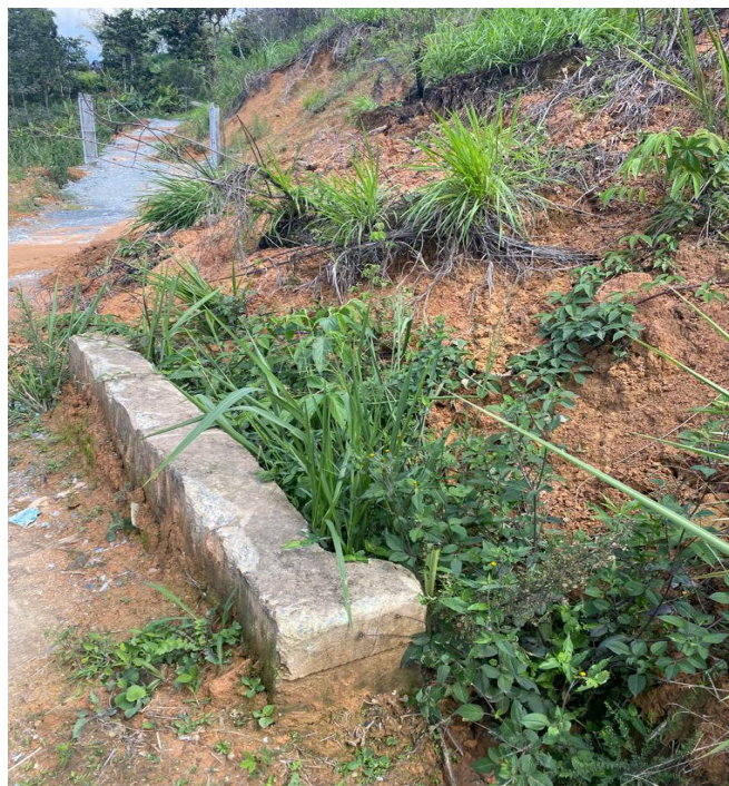
Figura 68 Alcantarilla de funcionalidad mala ubicada en la abscisa 1+304.000
