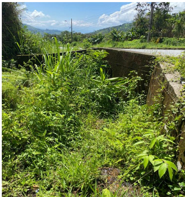
Figura 87 Alcantarilla de funcionalidad mala ubicada en la abscisa 14+960.50
