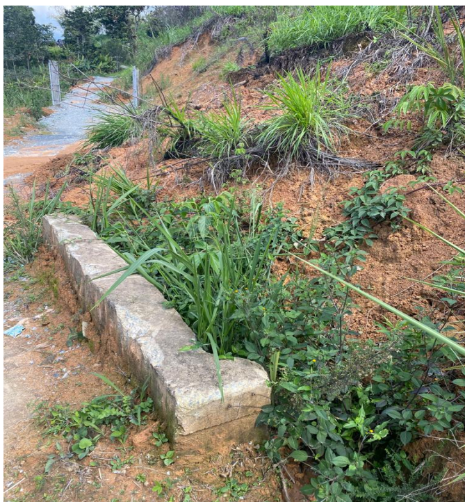
Figura 31 Alcantarilla de funcionalidad mala ubicada en la abscisa 1+304.000
