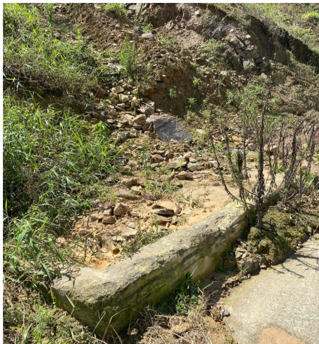
Figura 73 Alcantarilla de funcionalidad mala ubicada en la abscisa 2+360.45
