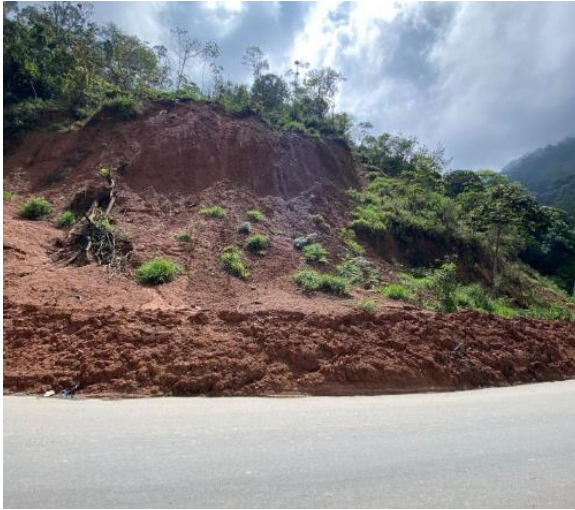
Figura 22 Derrumbe en abscisa 6+570.000
