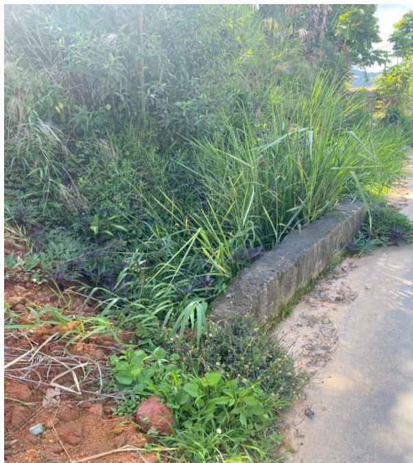
Figura 99 Alcantarilla de funcionalidad mala ubicada en la abscisa 23+812.30
