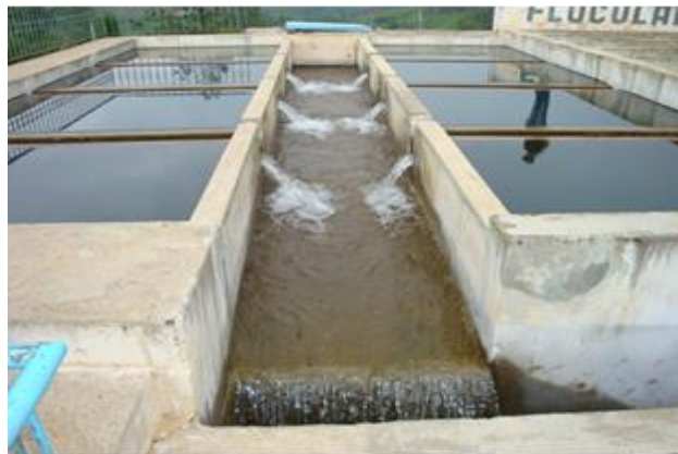
Ilustración 3. Sedimentadores - Situación actual
