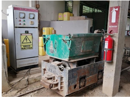
Baterías-Cargador de Locomotora
