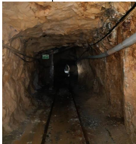
Instalacion electrica, de aire y agua.
