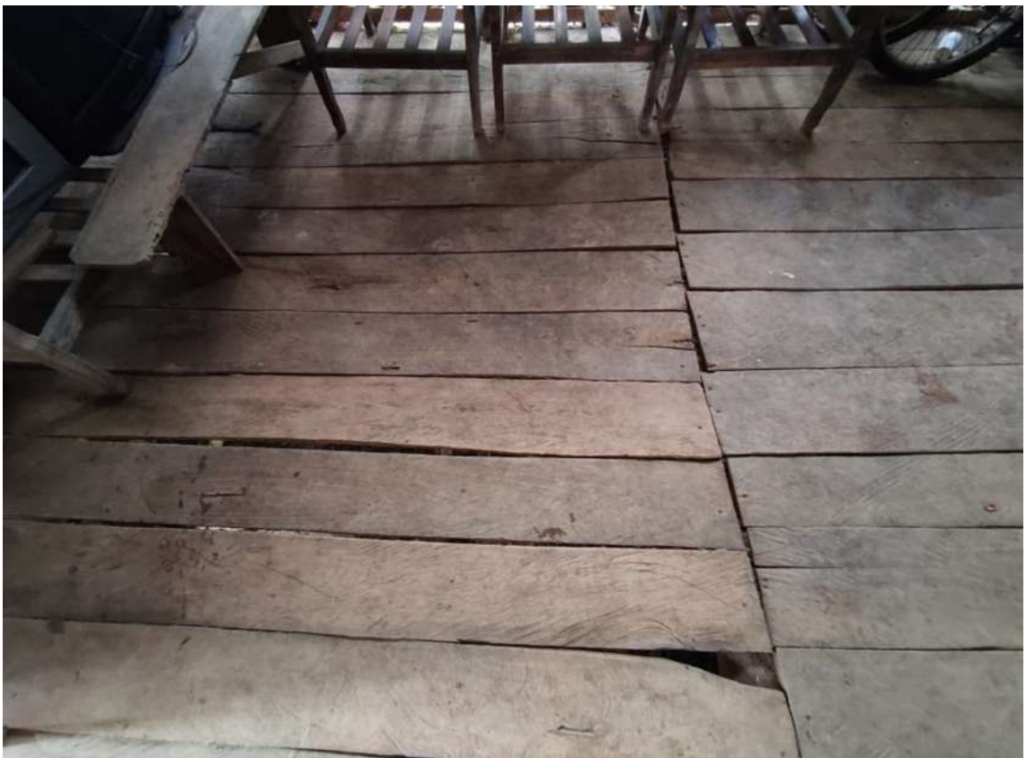
Anexo 7: En el interior, específicamente en el piso que es de tablas también refleja deterioro lo que puede causar riesgo a la adulta mayor.
