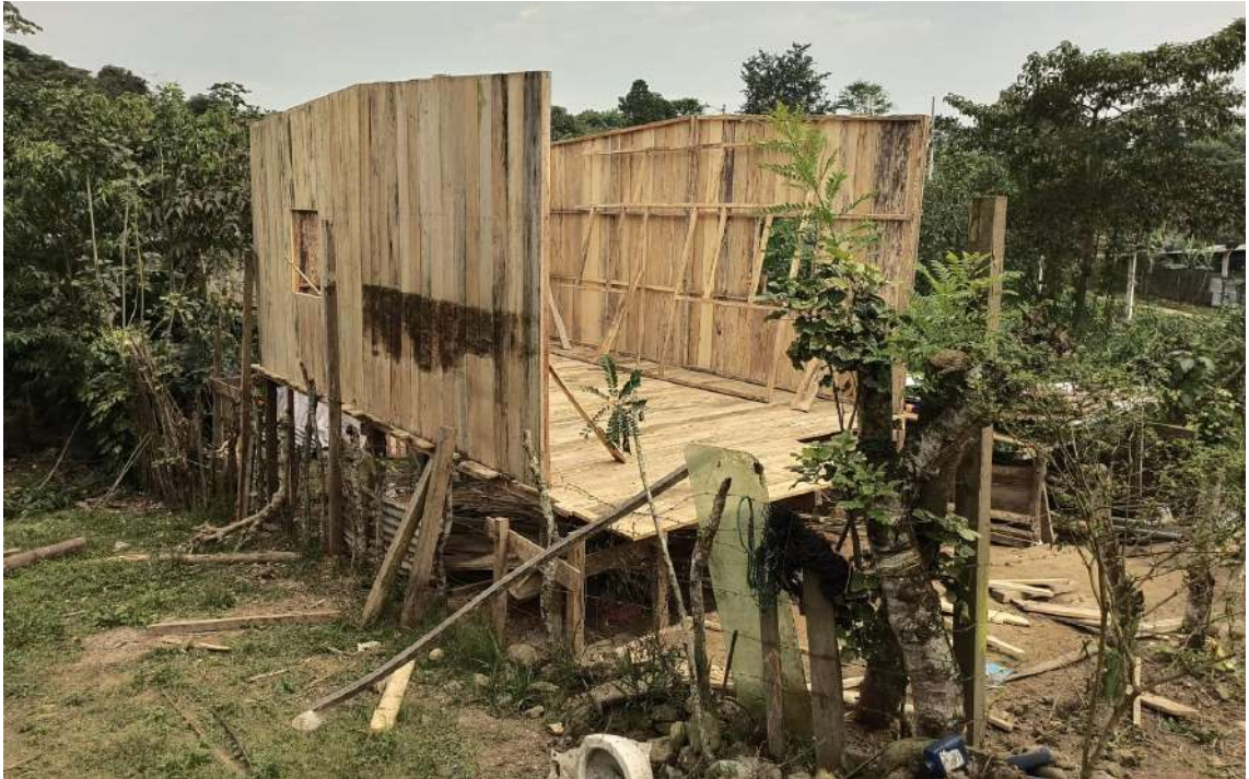
Anexo 10: Avance del ensablamiento de la vivienda por parte de los trabajadores municipales.
