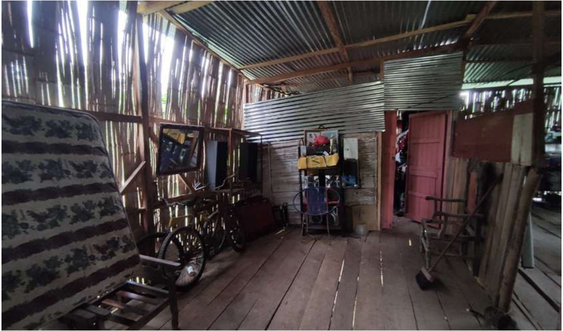
Anexo 6: Algunos de los materiales utilizados en la construcción mixta están deteriorándose.
