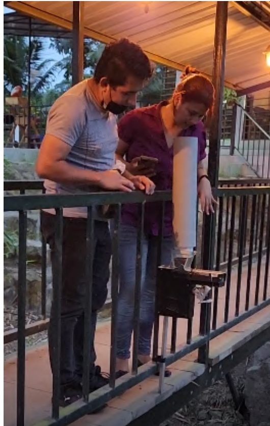
Anexo 7: Instalación y prueba del prototipo
