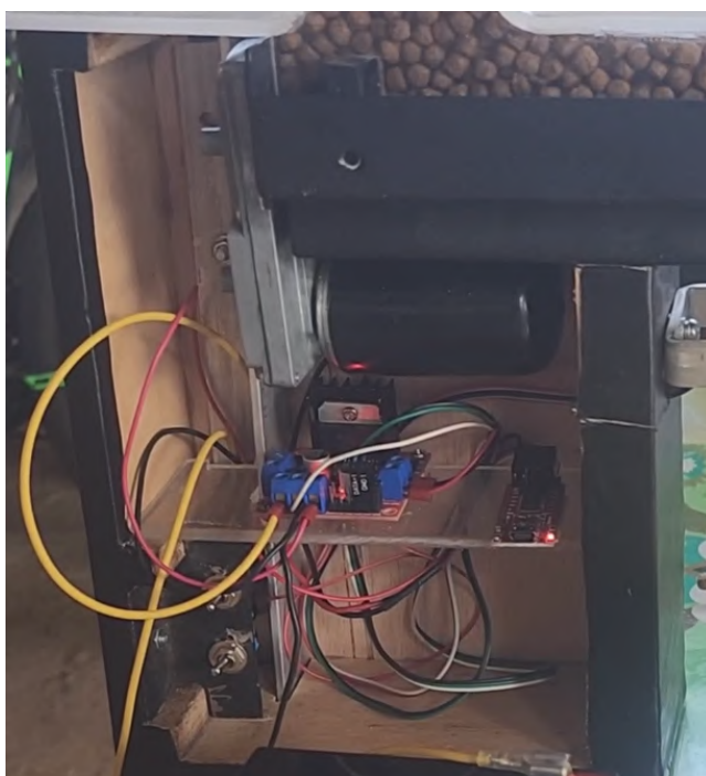
Ilustración 47: Caja contenedora de componentes electrónicos.
