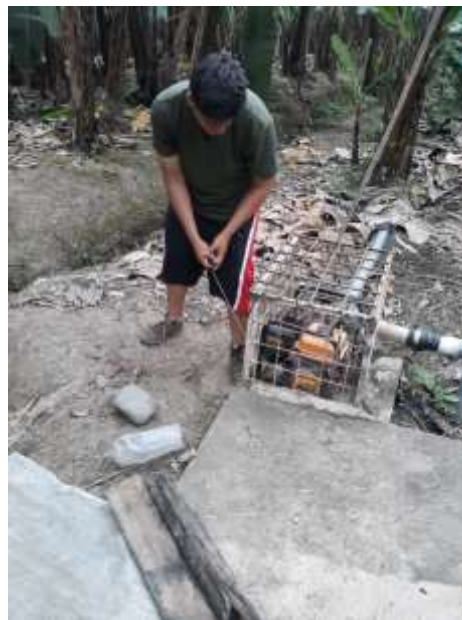
Activación del Sistema de riego por aspersión dentro de la plantilla.
