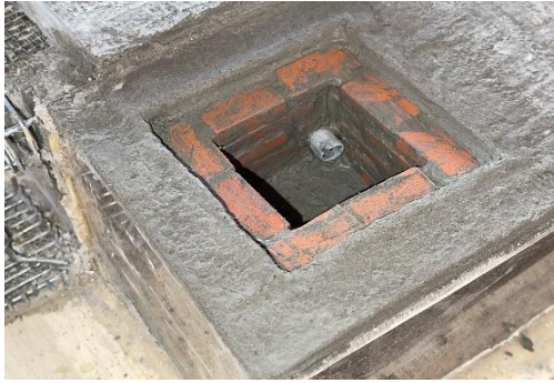
Imagen 37. Caja de registro
