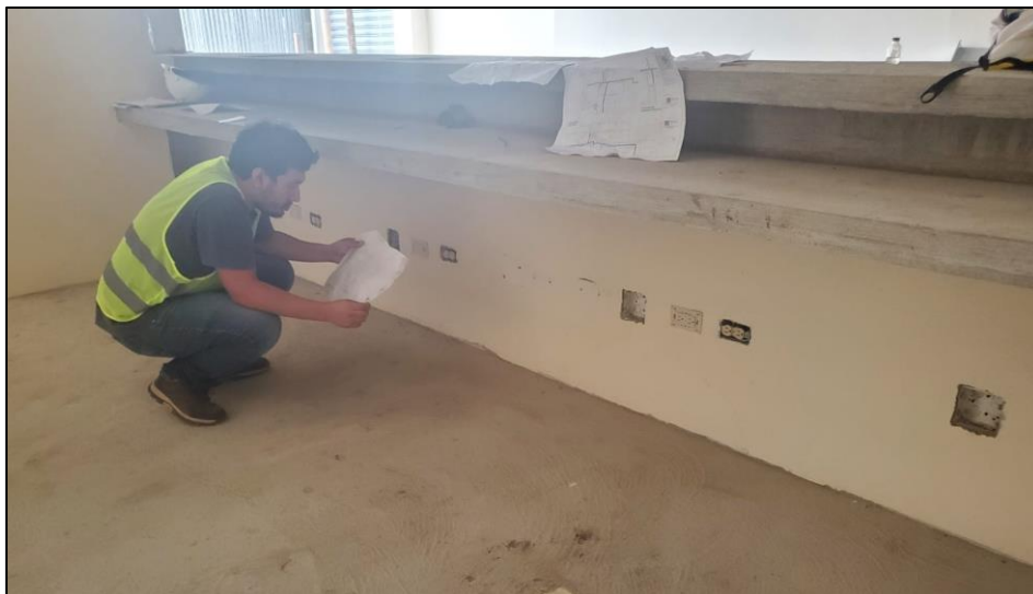
Imagen 2.2 Tomacorrientes instalados en Área de Facturación
