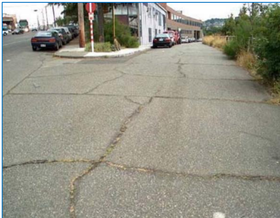
Figura 3. Grieta de reflexión de junta
