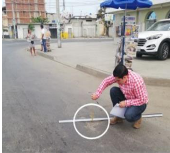
Figura 4. Huecos en avenida Circunvalación Sur de Machala
