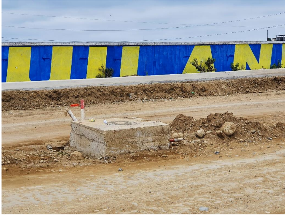
Falta de señalética en áreas críticas
