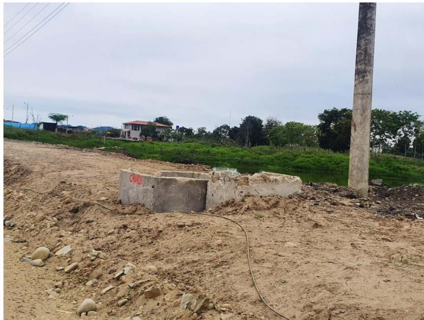
Falta de señalética en áreas críticas
