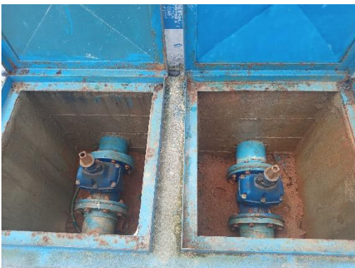
Imagen 5 Válvulas de paso de agua cruda a FLA 1 y 2.
