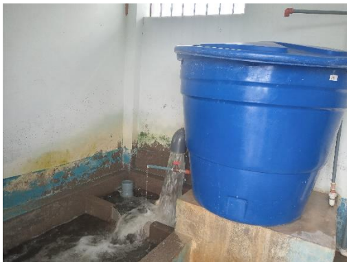
Imagen 9 Tanque de 500 L.
