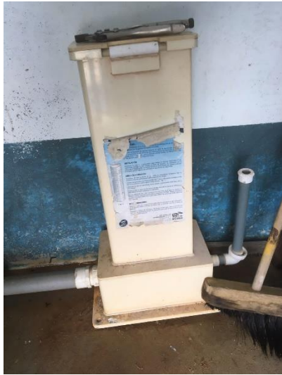
Imagen 13 Clorador Automático dañado
