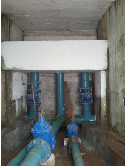
Imagen 7 Distribución del agua filtrada.
