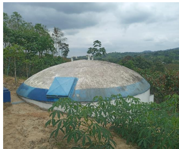
Imagen 12 Tanque de reserva.
