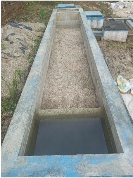
Imagen 1 FGDi fuera de operación.
