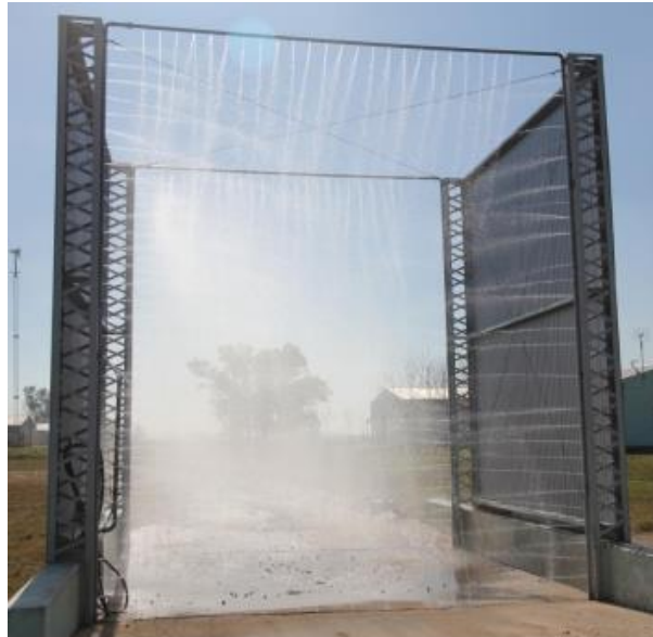
Imagen 9. Arco de desinfección para vehículos. Fuente: (2).
