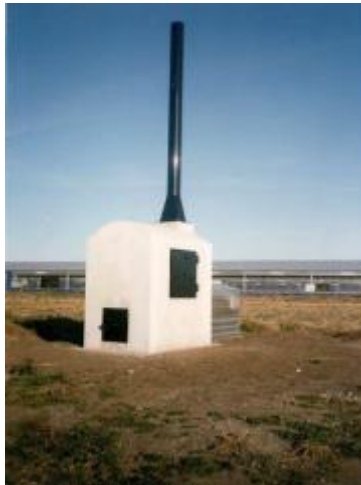
Imagen 23. Horno de incinerador Fuente: (4)
